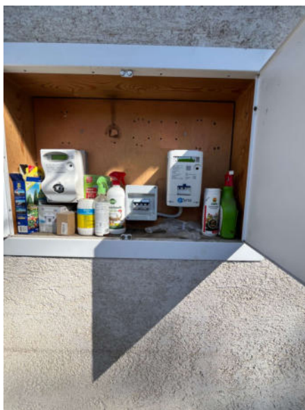
Contatori nel vano al piano terra già predisposti da allacciare
