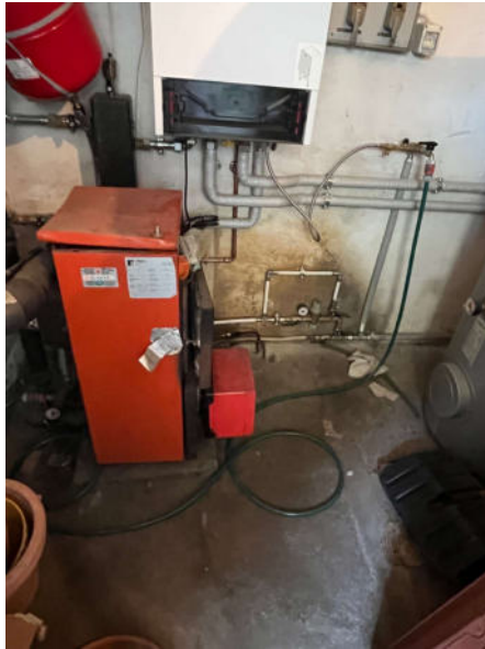
Caldaia al Piano terra vano comune.
