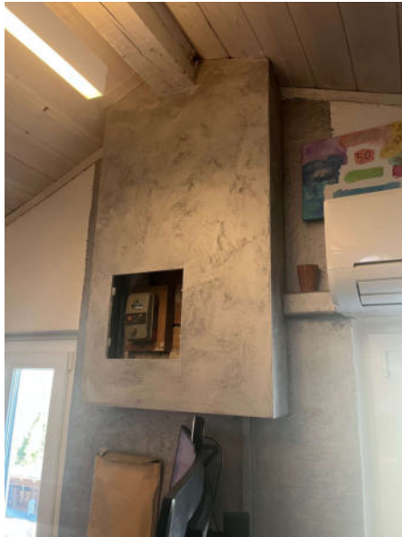
Blocco in cartongesso sospeso con contatore elettrico generale
