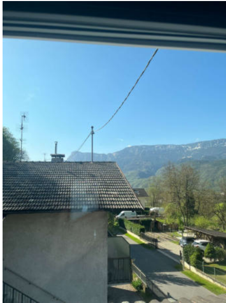
Linea elettrica aerea passante per i tetti della zona
