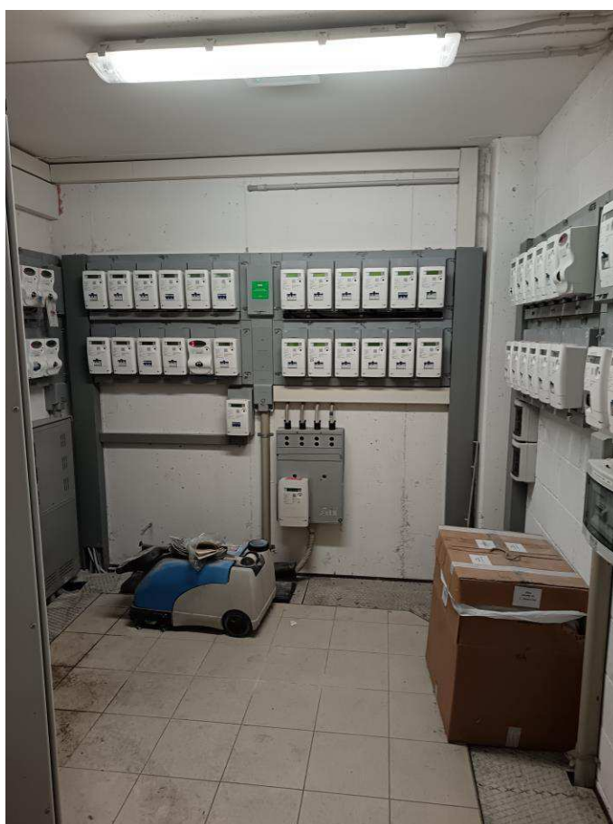
Locale contatori energia elettrica (sub 19), piano interrato
