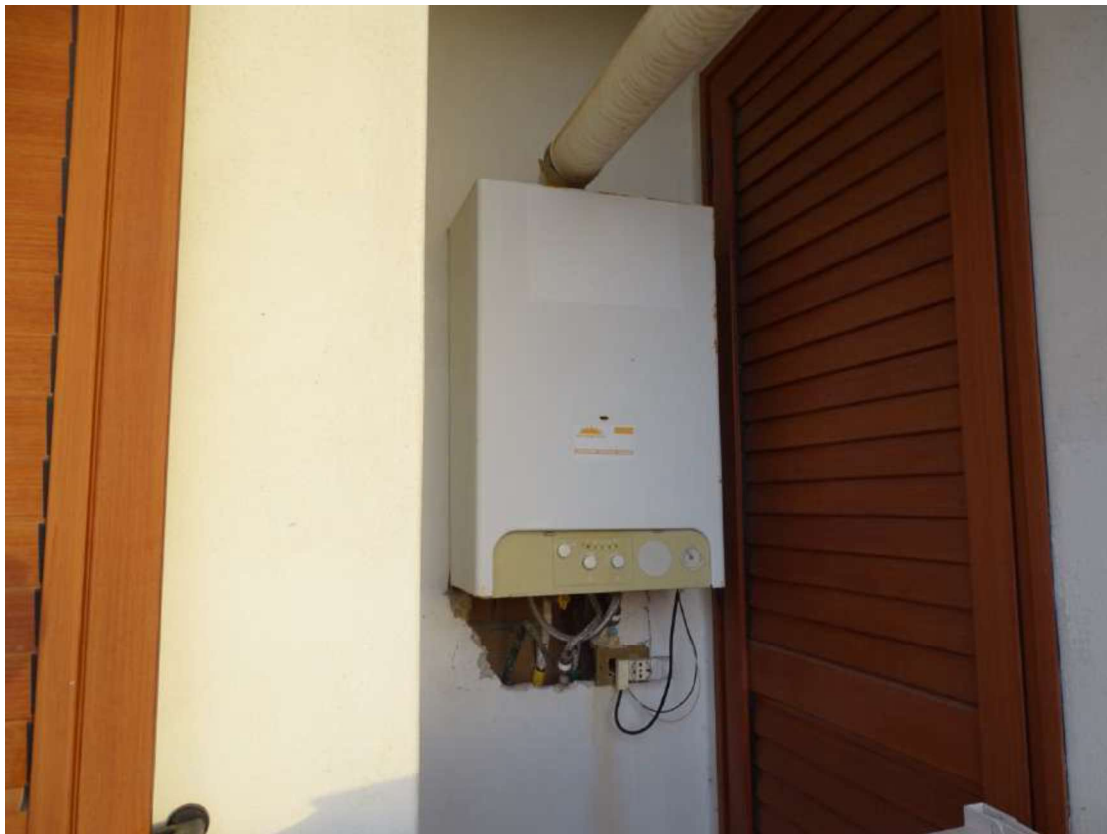
Foto 32 – Immobile “B” – Particolare caldaia a gas acqua sanitaria
