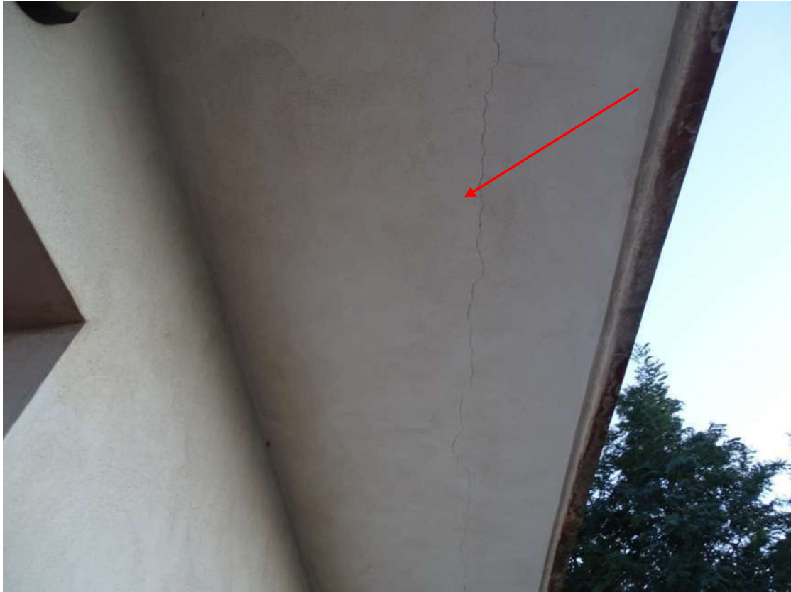
Foto 7 – Vista sotto balcone immobile "B" con una lesione dell'intonaco
