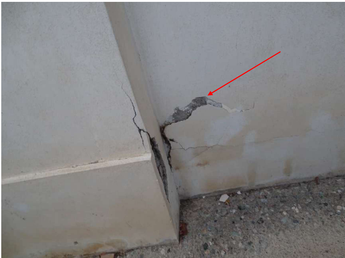
Foto 6 – Particolare della facciata ammalorata in determinate aree
