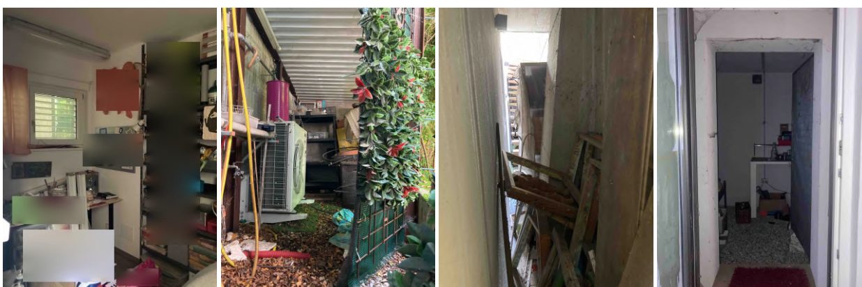
Viste interne: piano "sottostrada": vano "studio", vano tecnico esterno, porzione di "scannafosso" e vista accesso cantina edificata in assenza di titolo
