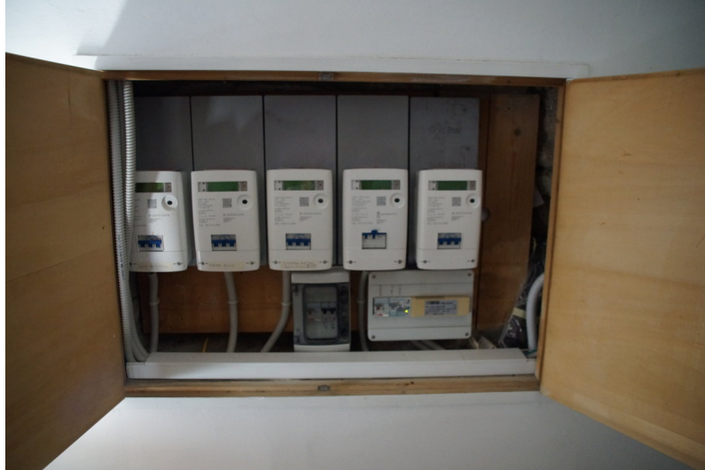
Foto n°5: particolare dell'alloggio dei contatori dei beni A e B posto all'interno del vano scala.
