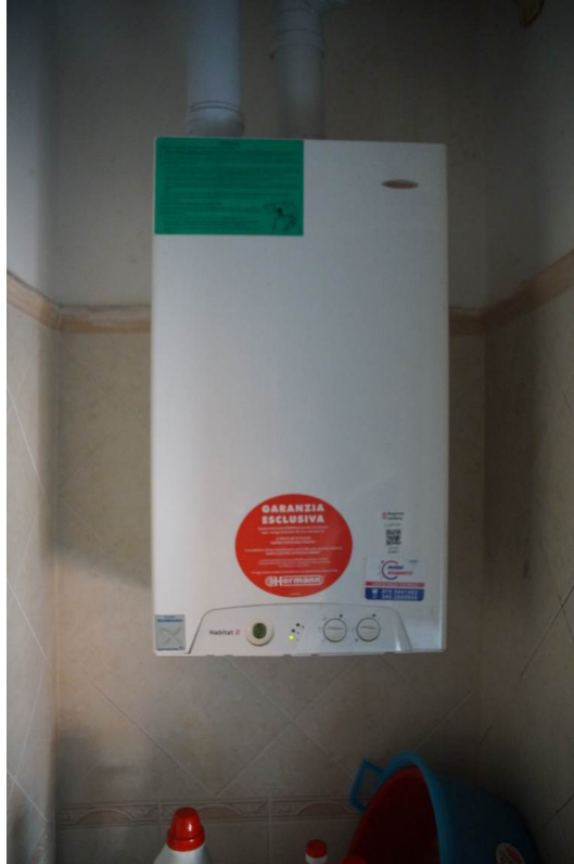
Foto n°15: particolare della caldaia a gas metano posizionata all'interno del bagno.
