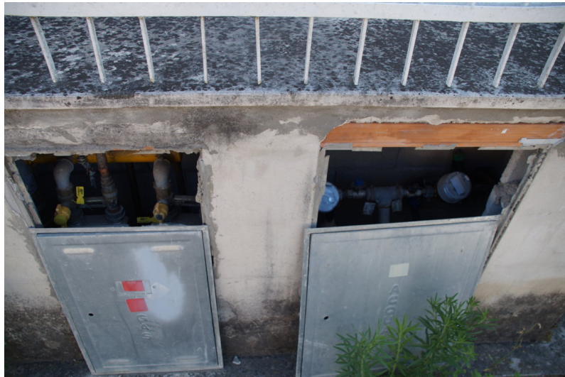
Foto n°6: particolare dell'alloggio dei contatori di gas ed acqua dei beni A e B posti all'esterno della corte condominiale lungo il lato Nord-Est.
