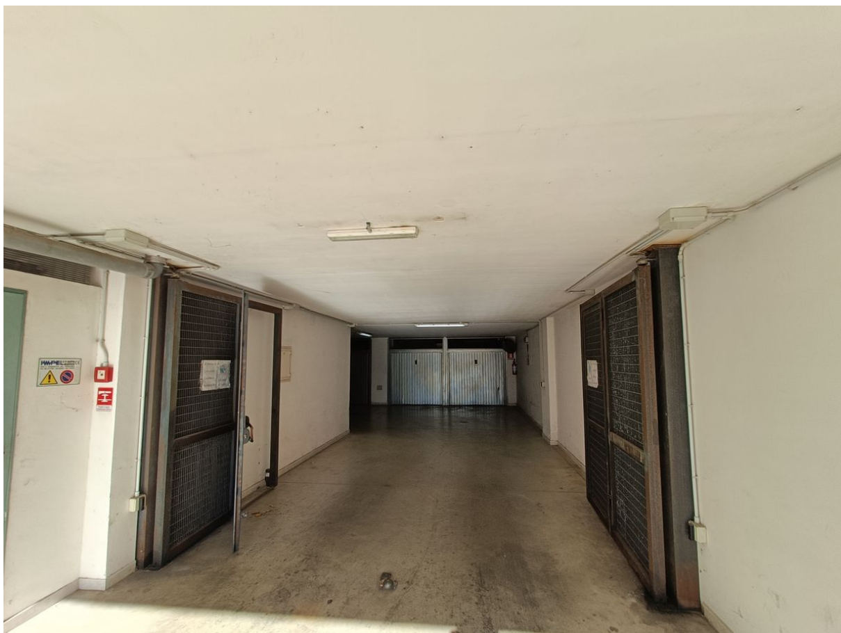
Autorimessa sita in Pescara alla Via di Sotto n.3, Scala D, Piano interrato, Palazzina B, distinta al Foglio n.18 Particella n.2874 Sub. n.42
