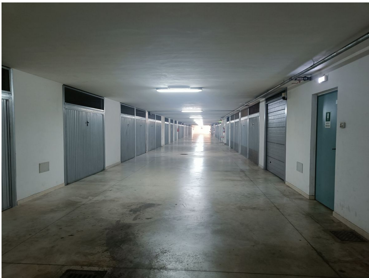
Autorimessa sita in Pescara alla Via di Sotto n.3, Scala D, Piano interrato, Palazzina B, distinta al Foglio n.18 Particella n.2874 Sub. n.42
