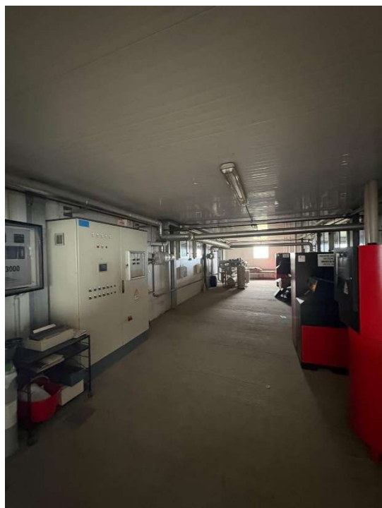
Locale tecnico celle
