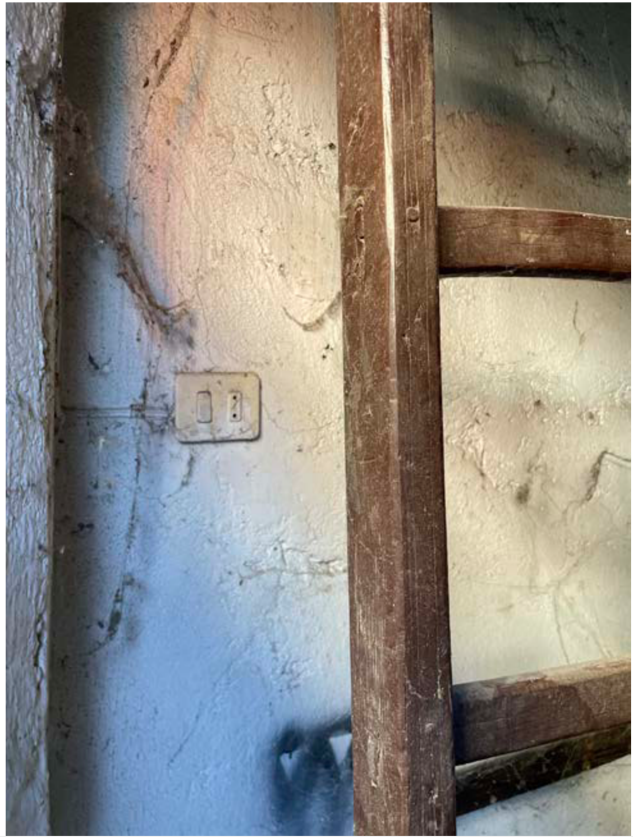
Fig. 6 - Interno Dettaglio impianto esistente
