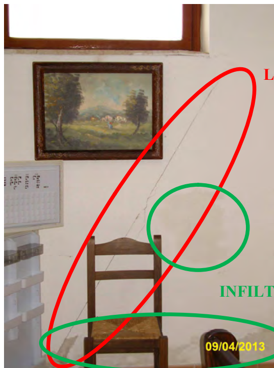
22 - Interno proprietà [redacted] : lesioni, infiltrazioni
