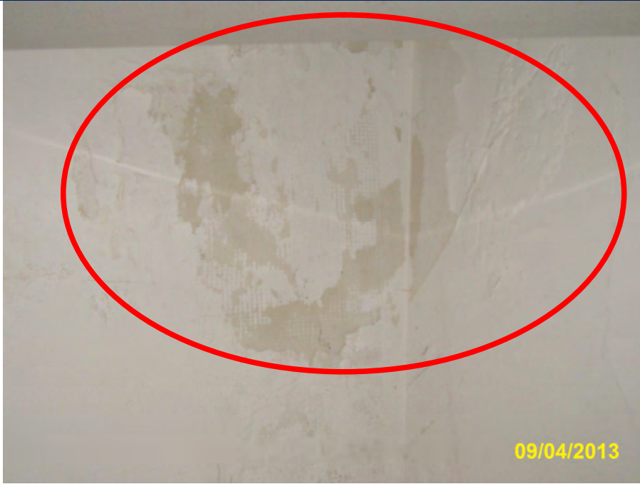
17 - Interno proprietà [redacted]: infiltrazione
