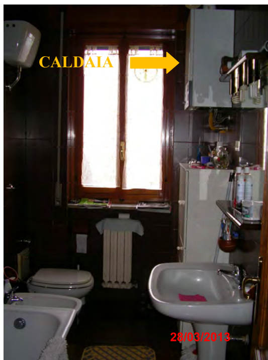
12 - Interno proprietà [REDACTED]: caldaia (1)
