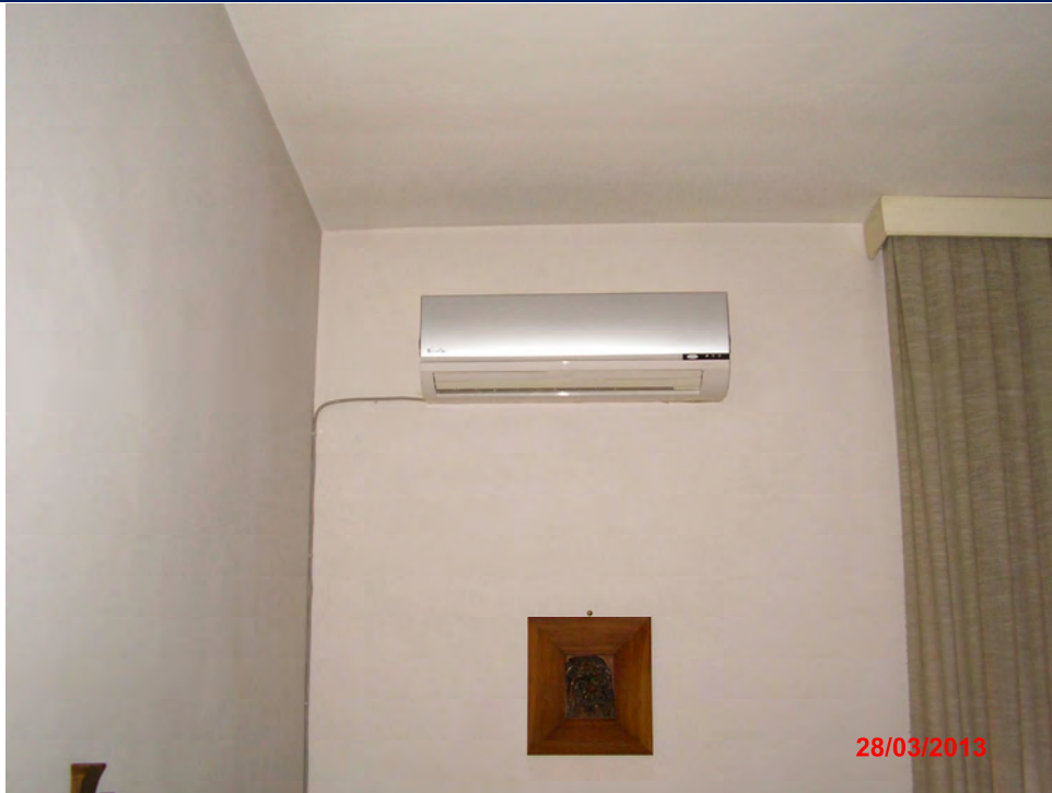
15 - Interno proprietà [REDACTED]: condizionatore
