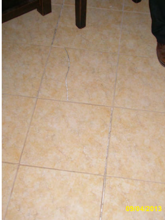
18 - Interno proprietà [redacted]: pavimento, lesioni
