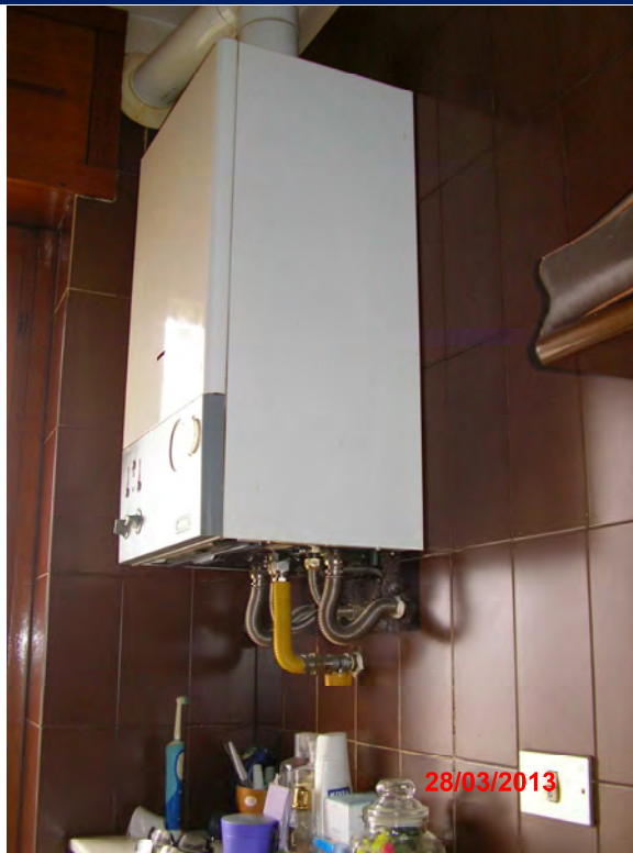
13 - Interno proprietà [redacted] : caldaia (2)
