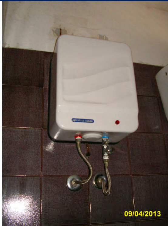
25 - Interno proprietà [redacted] : boiler elettrico
