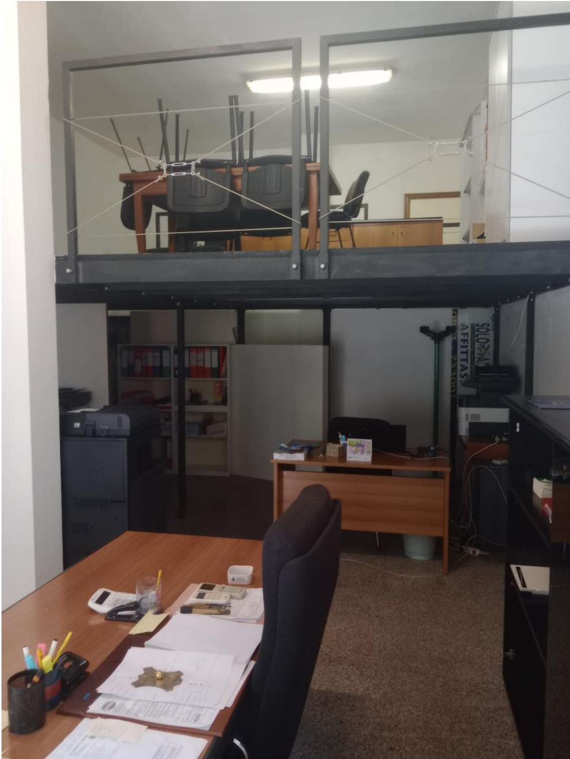
Vista Interna Negozio con soppalco non autorizzato
