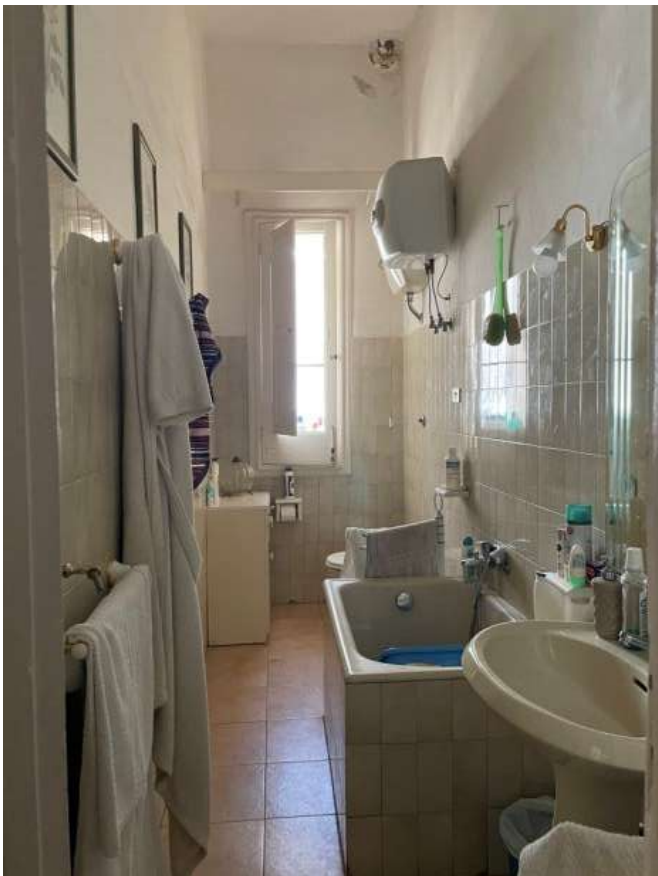
Figura 8. LOTTO UNICO: Immobile pignorato al F. 96, P.Ila 5921, Sub. 4 ubicato in Foggia alla Via Vittime Civili n. 68 (bagno).
