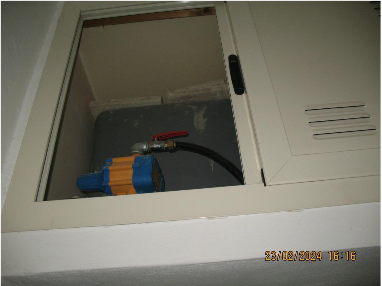
15-Bagno lato sud con ribassamento tetto per riserva idrica con serbatoio in polietilene e motore pompa di sollevamento acqua
