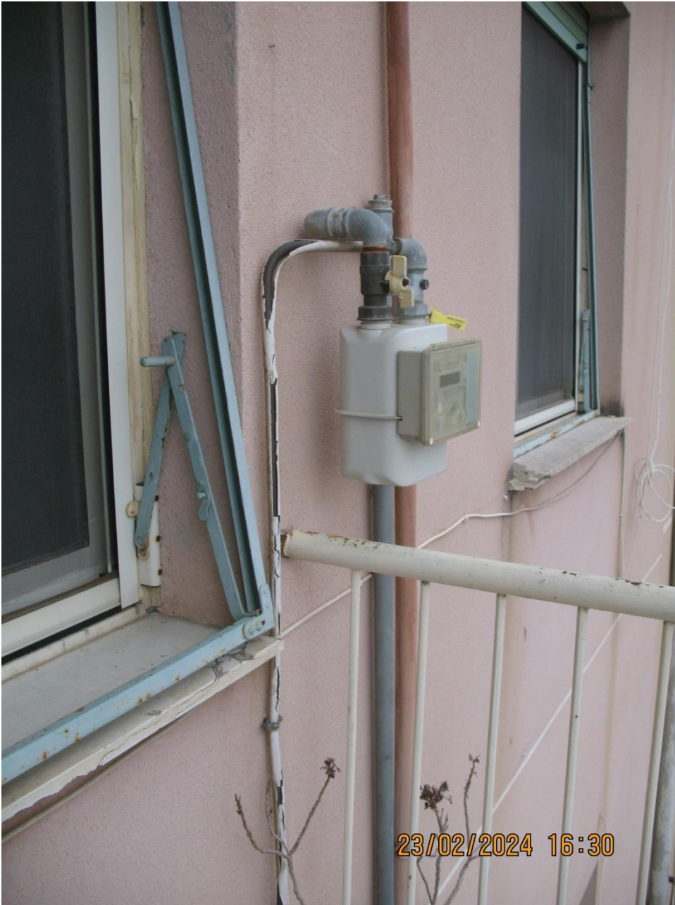
30-Allaccio gas con misuratore consumi dal balcone prospiciente su Via Gorizia, con particolare dell'infisso dotato di telaio a semi-imbotte interna e guida mobile dell'avvolgibile
