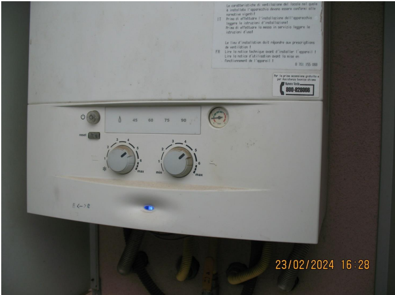
21-Caldaia esterna nel balcone
