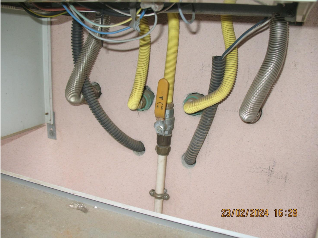
22-Caldaia esterna nel balcone
