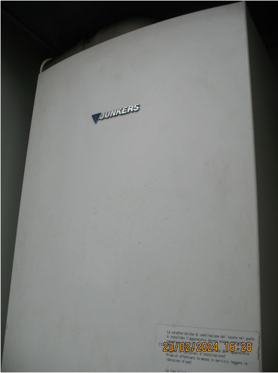
20-Caldaia esterna nel balcone
