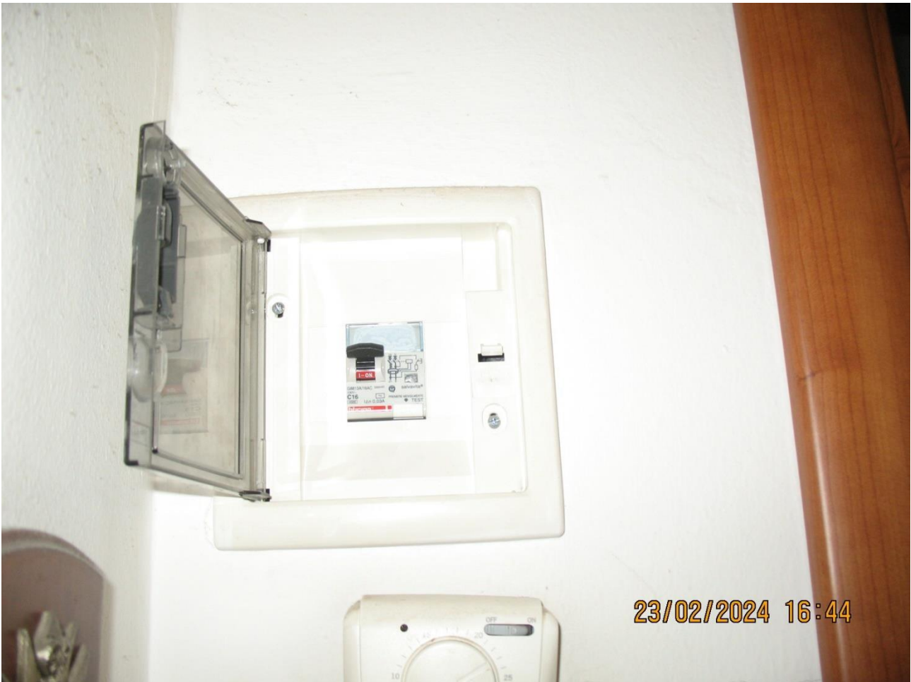
47-Interruttore differenziale e termostato all'interno del vano corridoio-disimpegno
