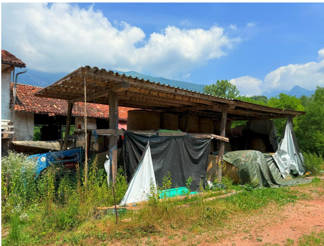
Foto 08: tettoia abusiva insistente sulla particella 127
