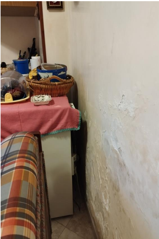
Danni da infiltrazione d'acqua – sogg/cucina
