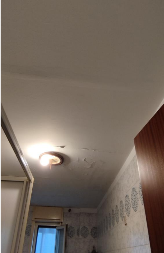
Danni da infiltrazione - bagno
