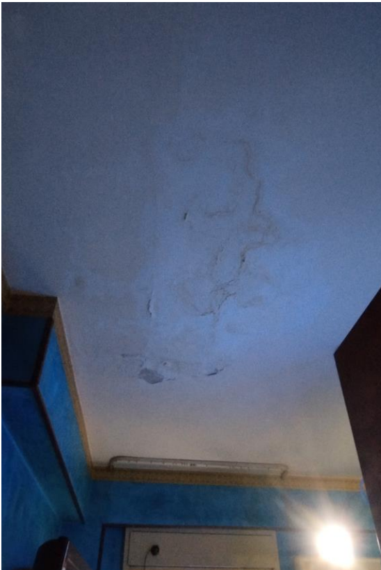
Danni da infiltrazione - camera da letto
