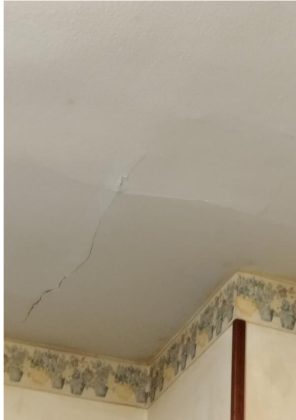
Infiltrazione proveniente da piano superiore
