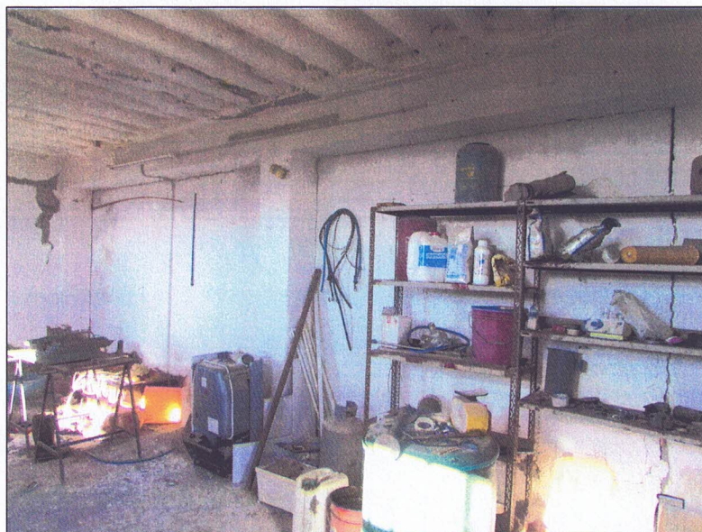
foto 20-21 - Foto interne del deposito con struttura in cls armato. Internamente sono presenti lesioni nella muratura con mancanze di intonaco e macchie da dilavamento.
