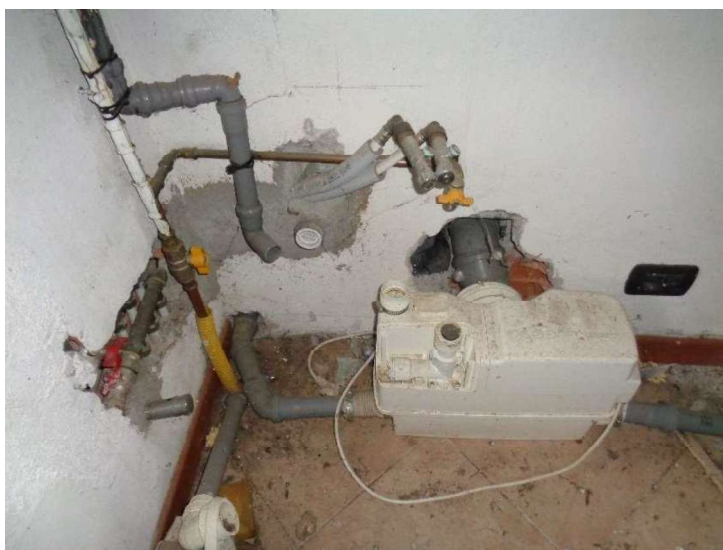
Impianto per lo scarico dei servizi con annesso apparecchio trituratore da sostituire completamente
