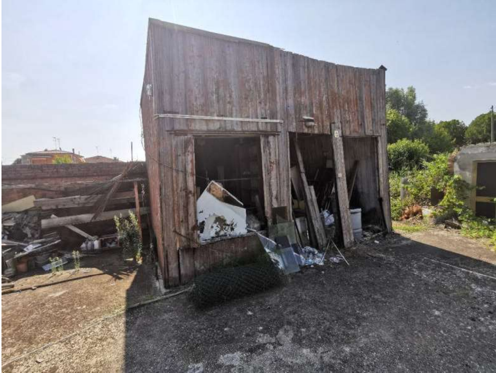
FOTOGRAFIA N.15 - particolare manufatto non autorizzato
