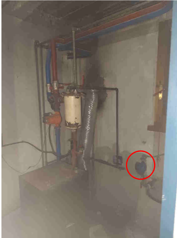
PIANO TERRA-CENTRALE TERMICA CON CONTATORE IDRICO
