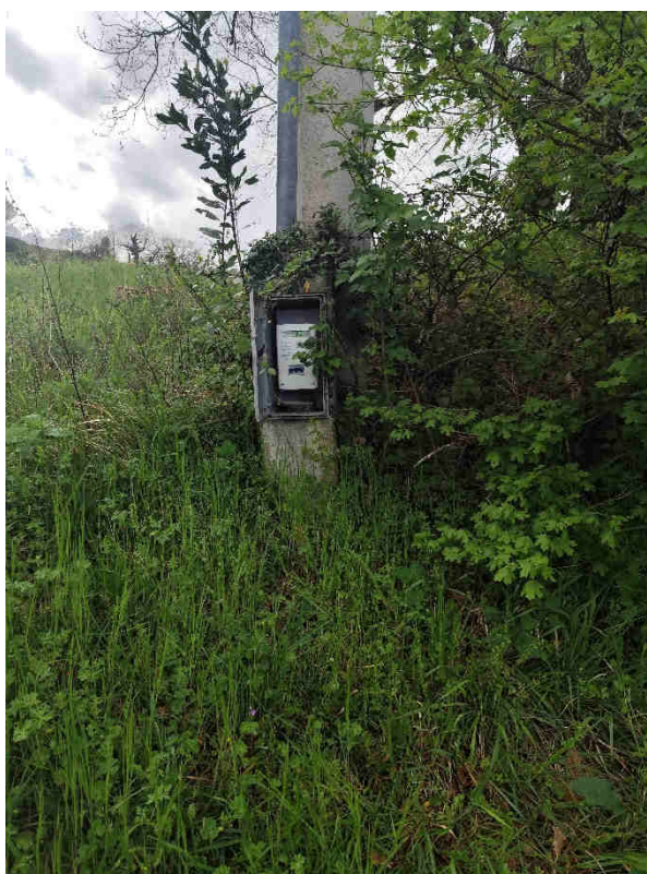
CONTATORE ELETTRICO SU PALO LATO STRADA
