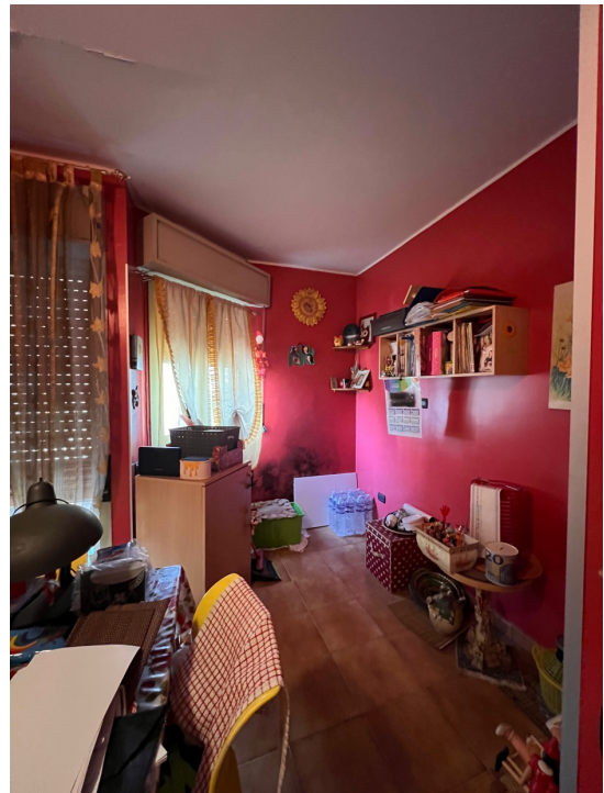
Figura 11 – Cucina: sul muro interno che dà sulla terrazza è presente una evidente macchia di muffa
