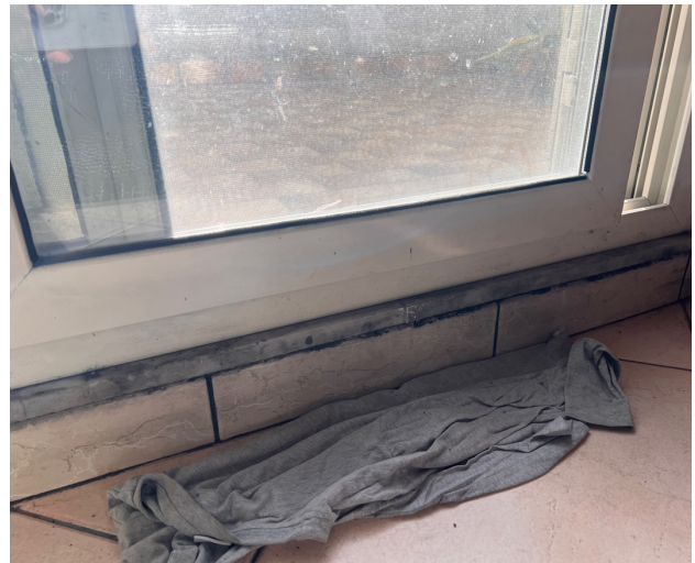
Figura 9 – Sotto portafinestra della camera da letto: si nota che la pavimentazione esterna si trova a quota più alta rispetto al pavimento interno
