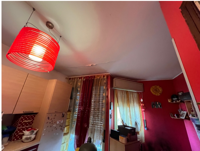
Figura 10 – Cucina: si nota il controsoffitto danneggiato probabilmente per effetto di infiltrazioni d'acqua dal tetto
