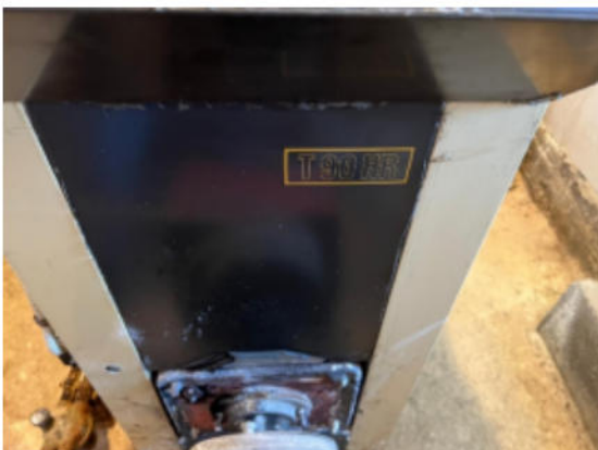
TARGA CALDAIA E BOILER ELETTRICO
