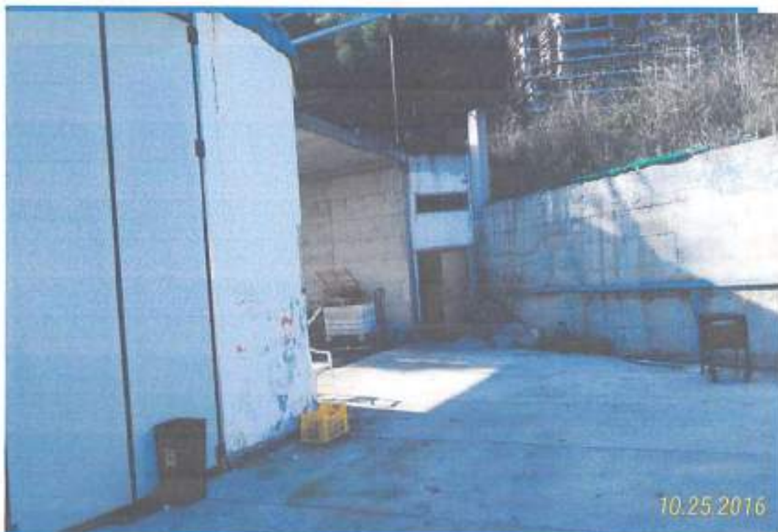
Foto 3 – IMMOBILE A – Vista retro con ingresso locale compressori
