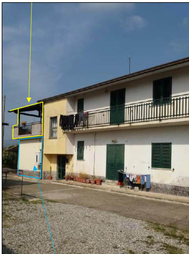
Foto A – Lato Est Ampliamento 2 (Abusivo)
