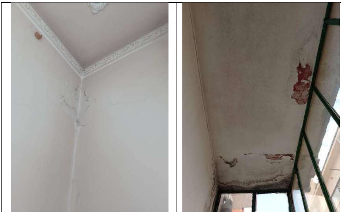
Foto 69. Particolari dei problemi di defogliazione della pittura ed ammaloramento da infiltrazione di acqua proveniente dalla terrazza, presenti al piano Terzo
