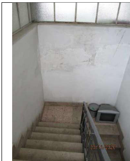
Foto 7. Particolare delle due rampe di scala che servono gli appartamenti ai vari livelli del fabbricato
