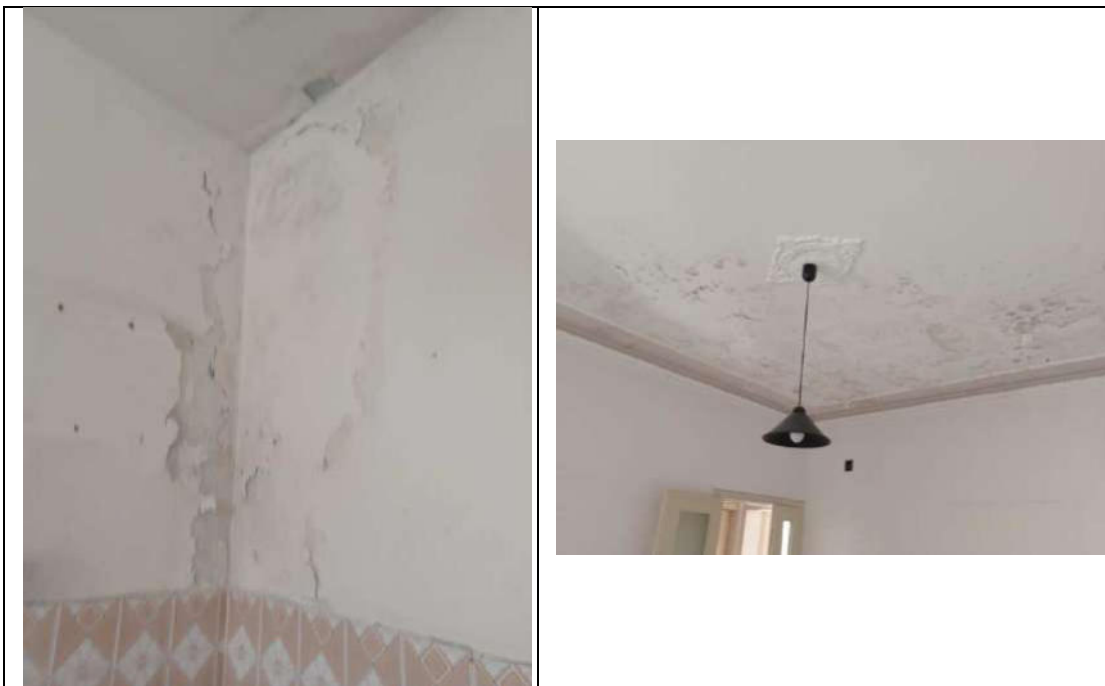
Foto 68. Particolari dei problemi di defogliazione della pittura ed ammaloramento da infiltrazione di acqua proveniente dalla terrazza, presenti al piano Terzo
