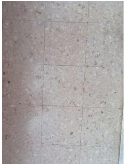
Foto 57. Particolare della tipologia di pavimentazione, in graniglia, presente sui Balconi Sud e Nord-Ovest dell'immobile, al piano Secondo
