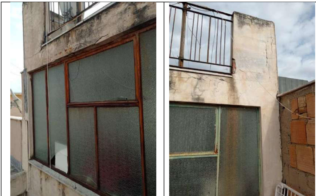
Foto 85 e 86. Particolari dei danni causati dalle intemperie e dall'assenza di manutenzione del fabbricato
