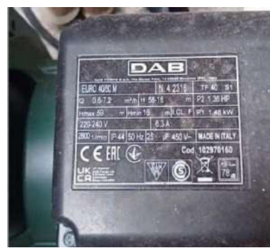
Foto 17 e 18. Particolare del motore dell'impianto autoclave
