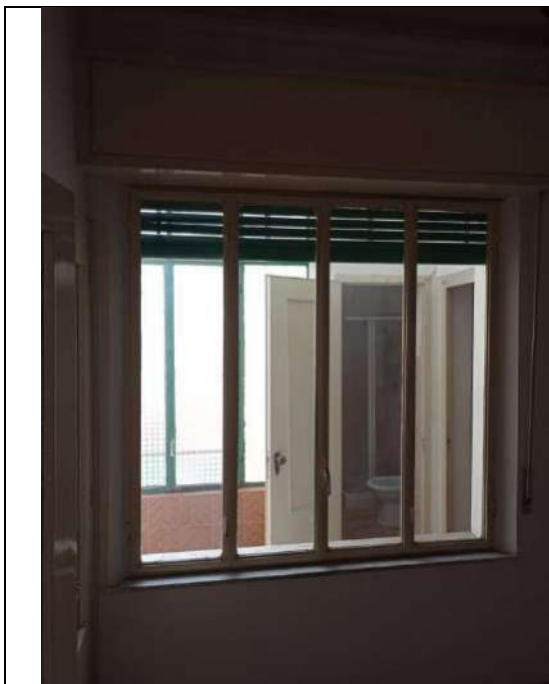
Foto 61. Particolare della tipologia di finestra, in ferro, a quattro ante, vetro singolo, con avvolgibile in pvc
