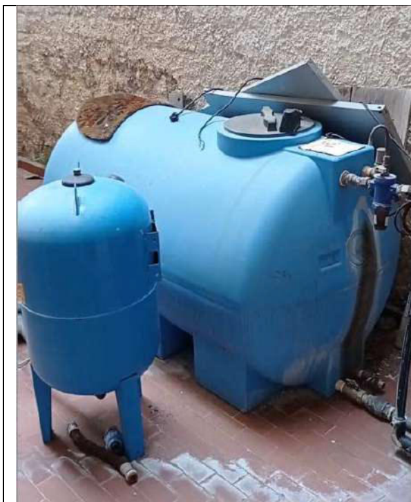
Foto 16. Particolare della cisterna di accumulo acqua per alimentare le varie utenze dei beni, oggetto di pignoramento
