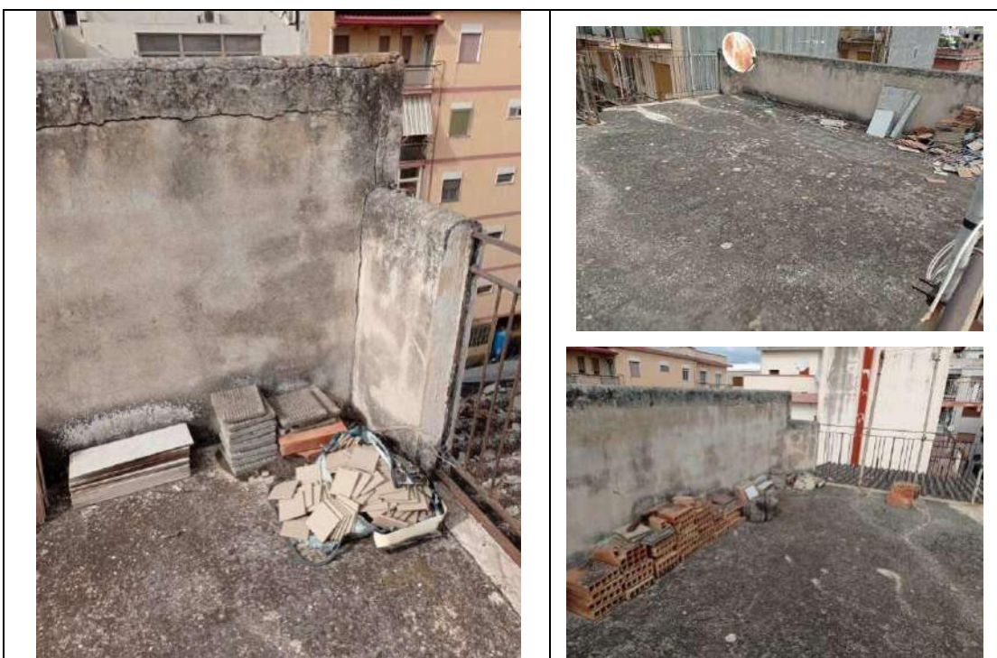
Foto 87, 88 e 89. Particolari dei danni rilevati sull'abbaino, dove si osservano parapetti crepati, assenza di impermeabilizzazione, nonché depositi di materiale inerte
