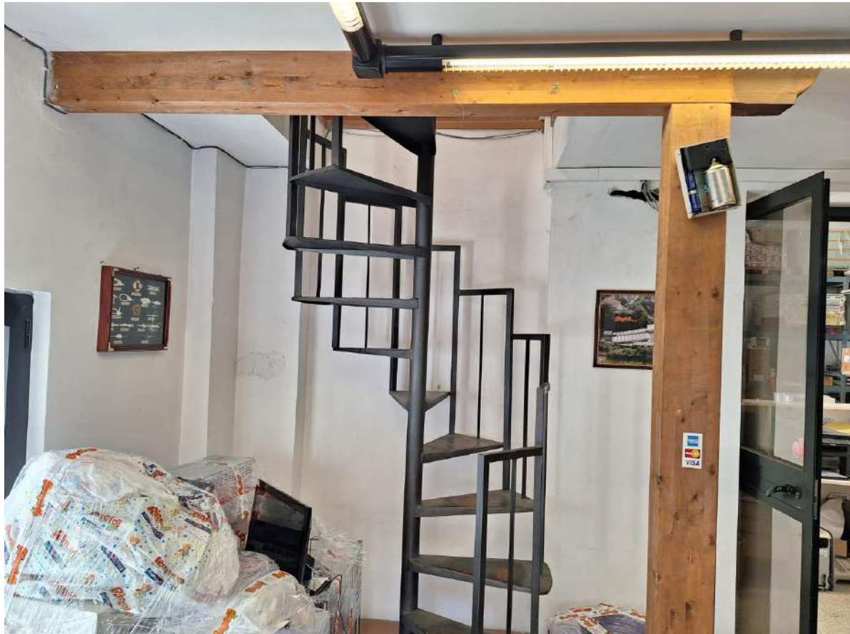
Foto n. 14 – Interno ufficio a Piano Terra particolare scala a chiocciola di collegamento al Piano Primo
