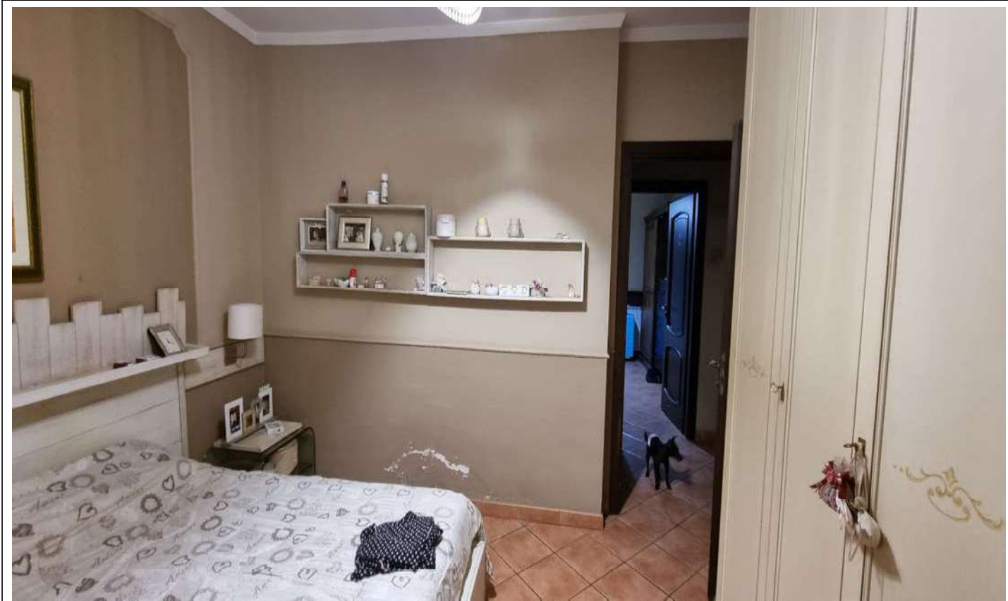
Allegato 20 – Camera da letto n. 3 e infiltrazioni di acqua su tramezzo
