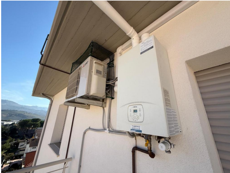
Foto 09 – Particolare caldaia e condizionatore
