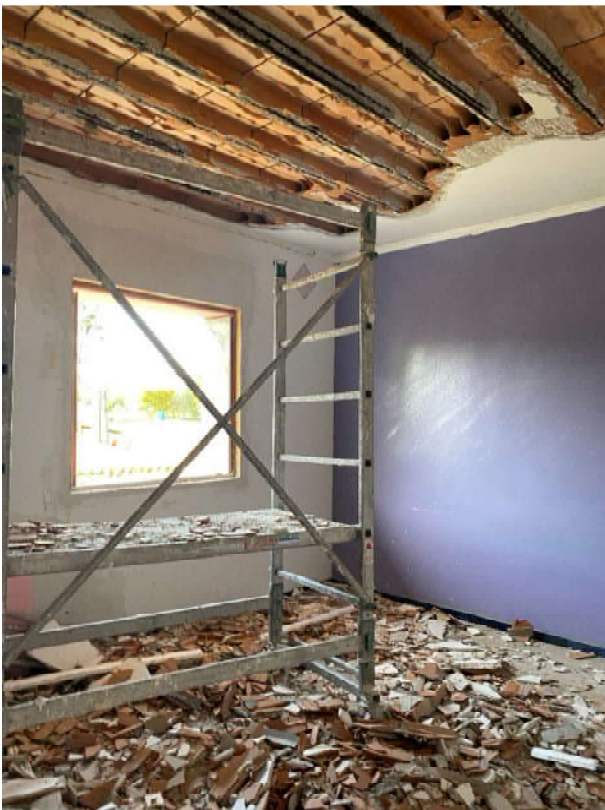
Foto 13: Vista cameretta con solaio di copertura sfondellato ancora da ripristinare
