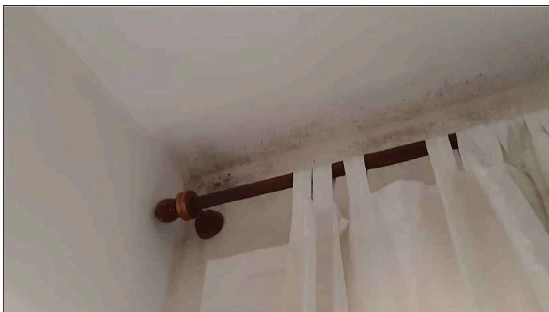
foto 14 - vista delle muffe presenti sopra alla finestra della camera matrimoniale.
