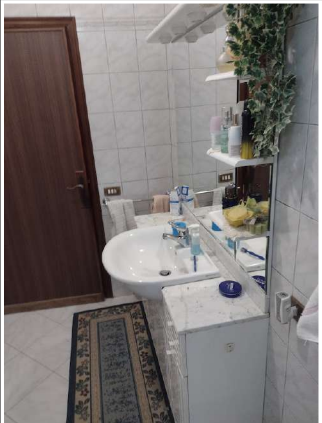
Interno bagno sub 8 senza verifica areoilluminante
