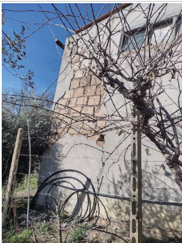
Part. Angolo lesionato fabbricato ex pollaio F.10 p.lla ...
