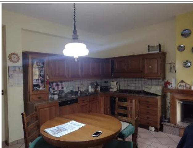
Interno ex cucina sub 8 senza verifica areoilluminante
