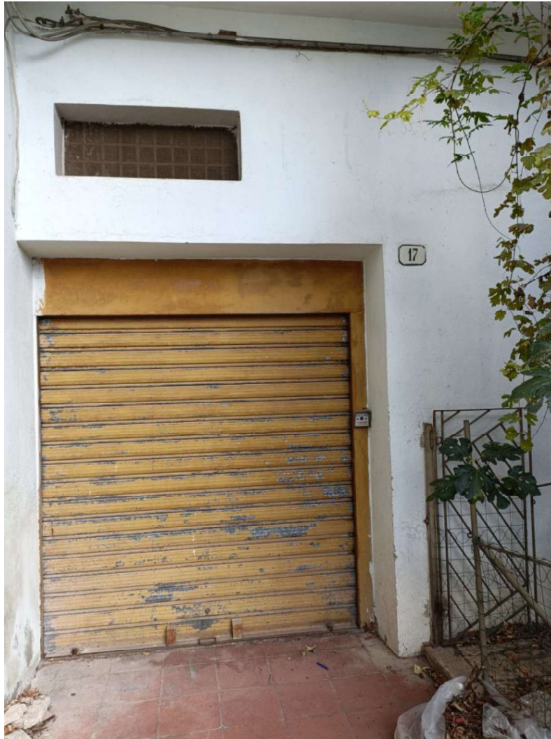
Figura 1 – Panoramica Ingresso Piano Terra, accesso Via Bellini, n. 17, Rionero in Vulture (PZ).
