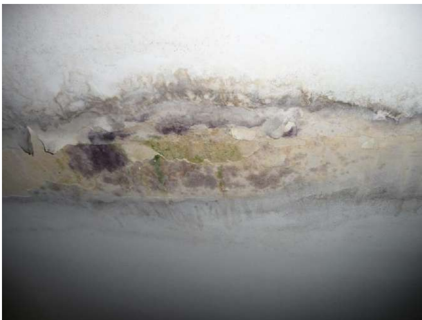
Foto n. 10 Infiltrazione dal tetto in soggiorno
