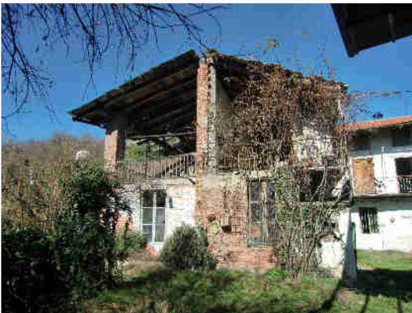
ALA DI FABBRICATO IN ADERENZA ALLA PROPRIETA' CONFINANTE (confine sulla linea del colmo del tetto)
