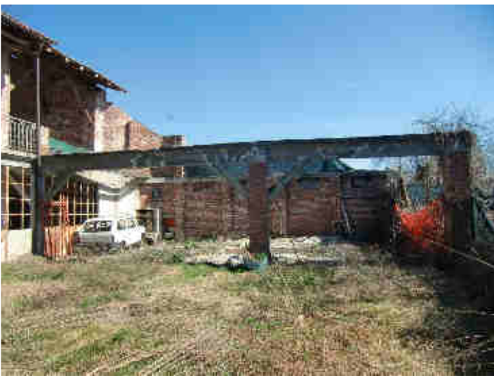
PORZIONE DI FABBRICATO PARZIALMENTE DEMOLITA (COLLABENTE)
