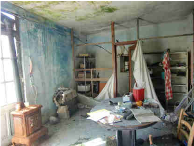
LOCALE DI SGOMBERO POSTO SOTTO IL TERRAZZO CON EVIDENTI SEGNI D'INGFILTRAZIONI DAL TERRAZZO SUPERIORE
