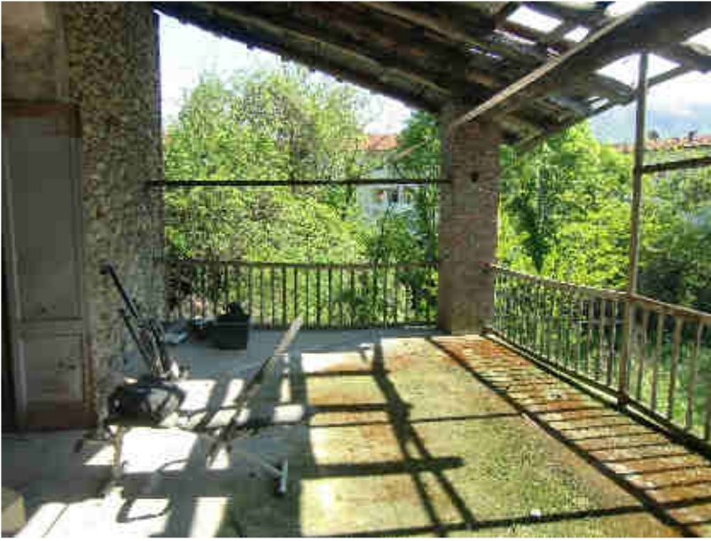
TERRAZZO COPERTO CON COPERTURA COMPLETAMENTE AMMALORATA
