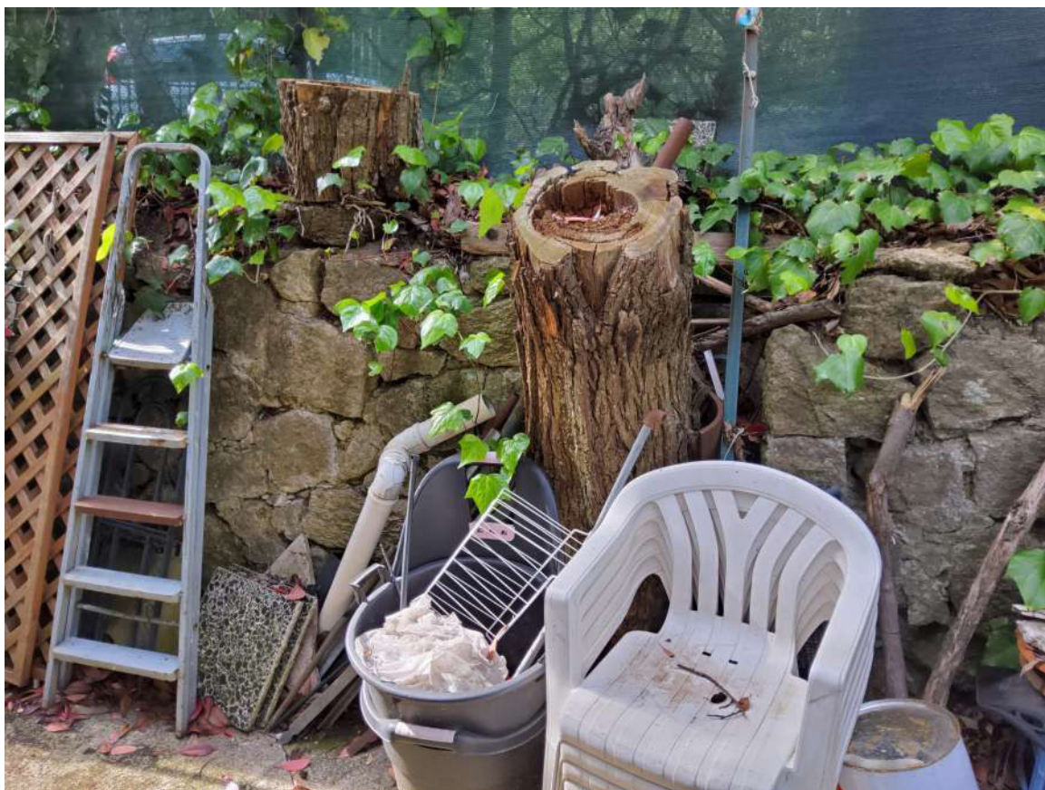
Foto 4: Muro di contenimento danneggiato
