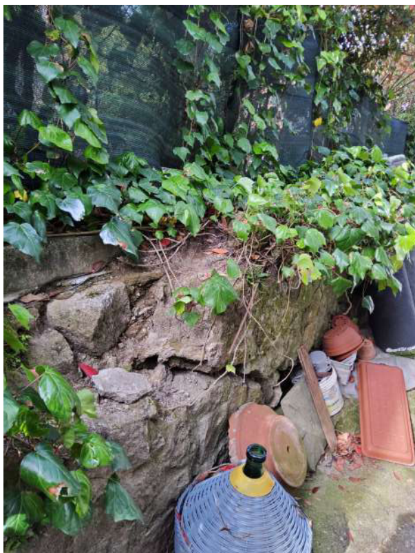
Foto 3: Muro di contenimento danneggiato
