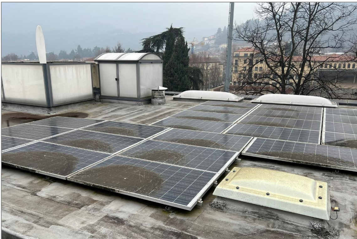
Figura 3 - Stato del campo fotovoltaico in copertura - lato S/SO
