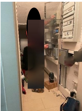
vano tecnico a servizio dell'imp. fotovoltaico
