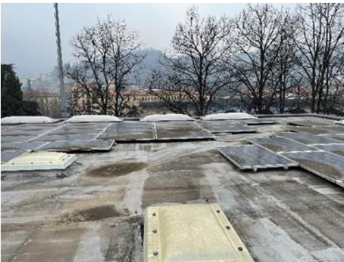
veduta pannelli impianto fotovoltaico
