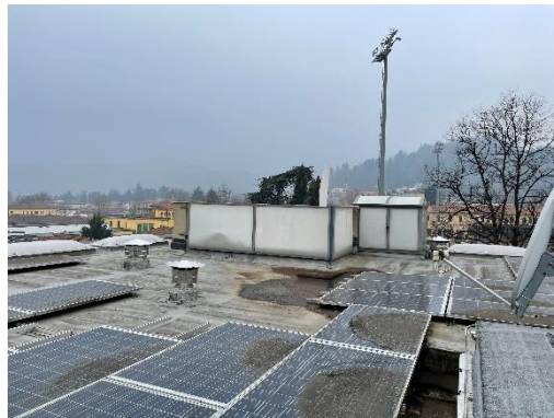
altra veduta pannelli impianto fotovoltaico
