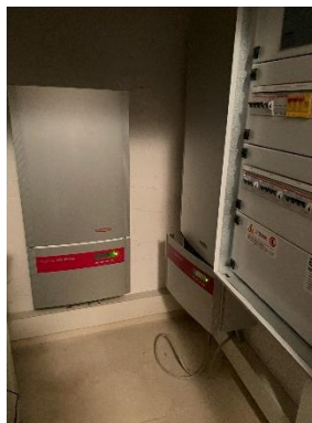
vano tecnico vista inverter
