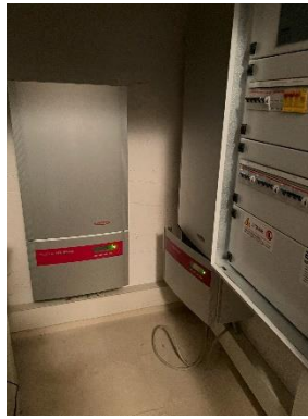
vano tecnico vista inverter
