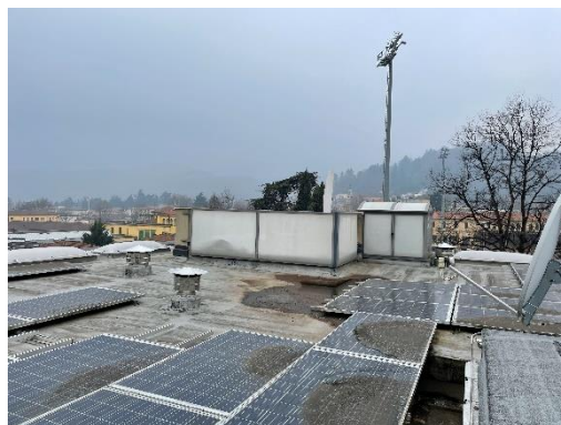
altra veduta pannelli impianto fotovoltaico
