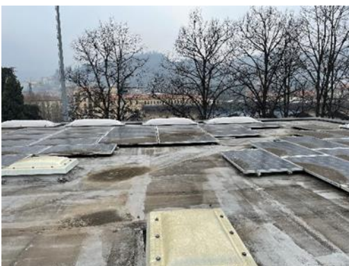
veduta pannelli impianto fotovoltaico
