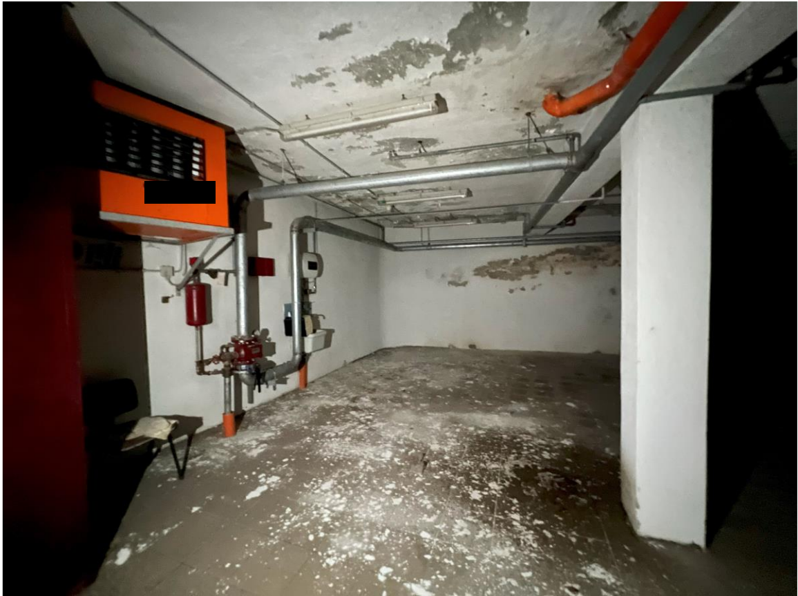
Foto 8. - Particolare soffitti interessati da infiltrazioni dal soprastante cortile
