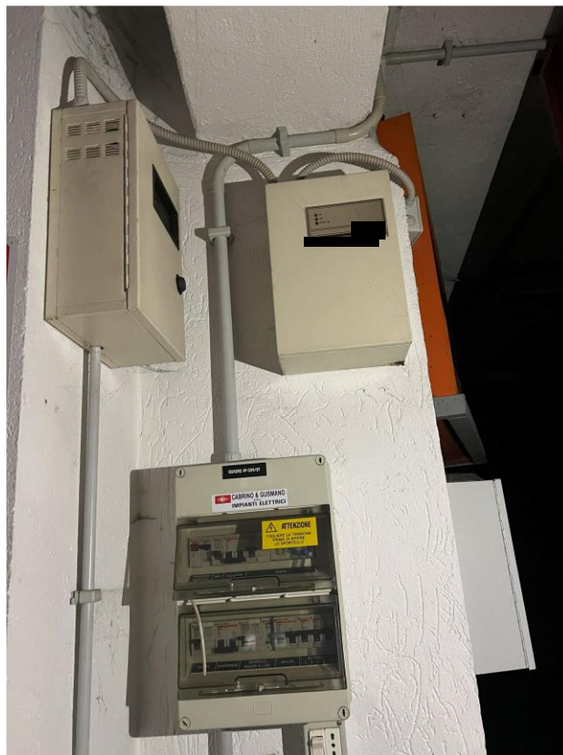
Foto 15. - Quadro impianto elettrico in disuso
