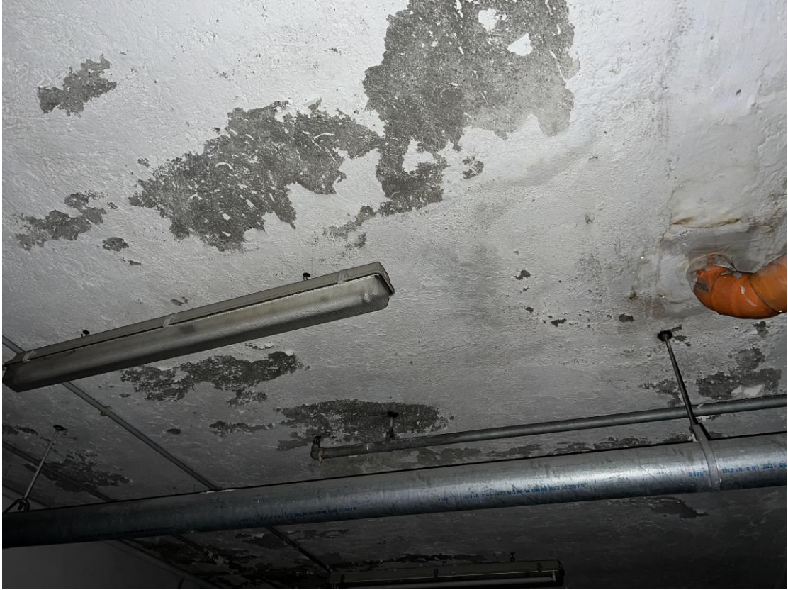
Foto 10. - Stato di degrado dei soffitti
