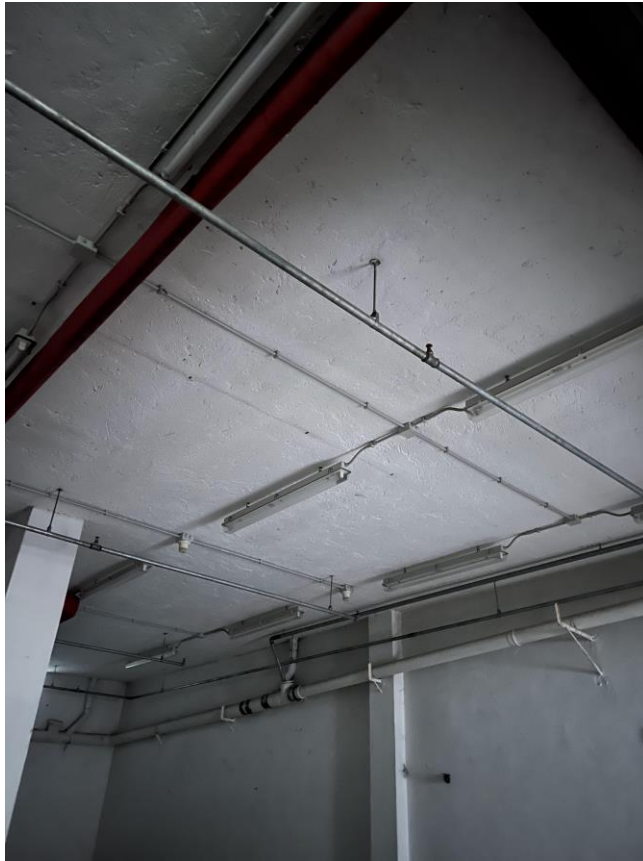
Foto 14. - Tubazioni impianto sprinkler a soffitto
