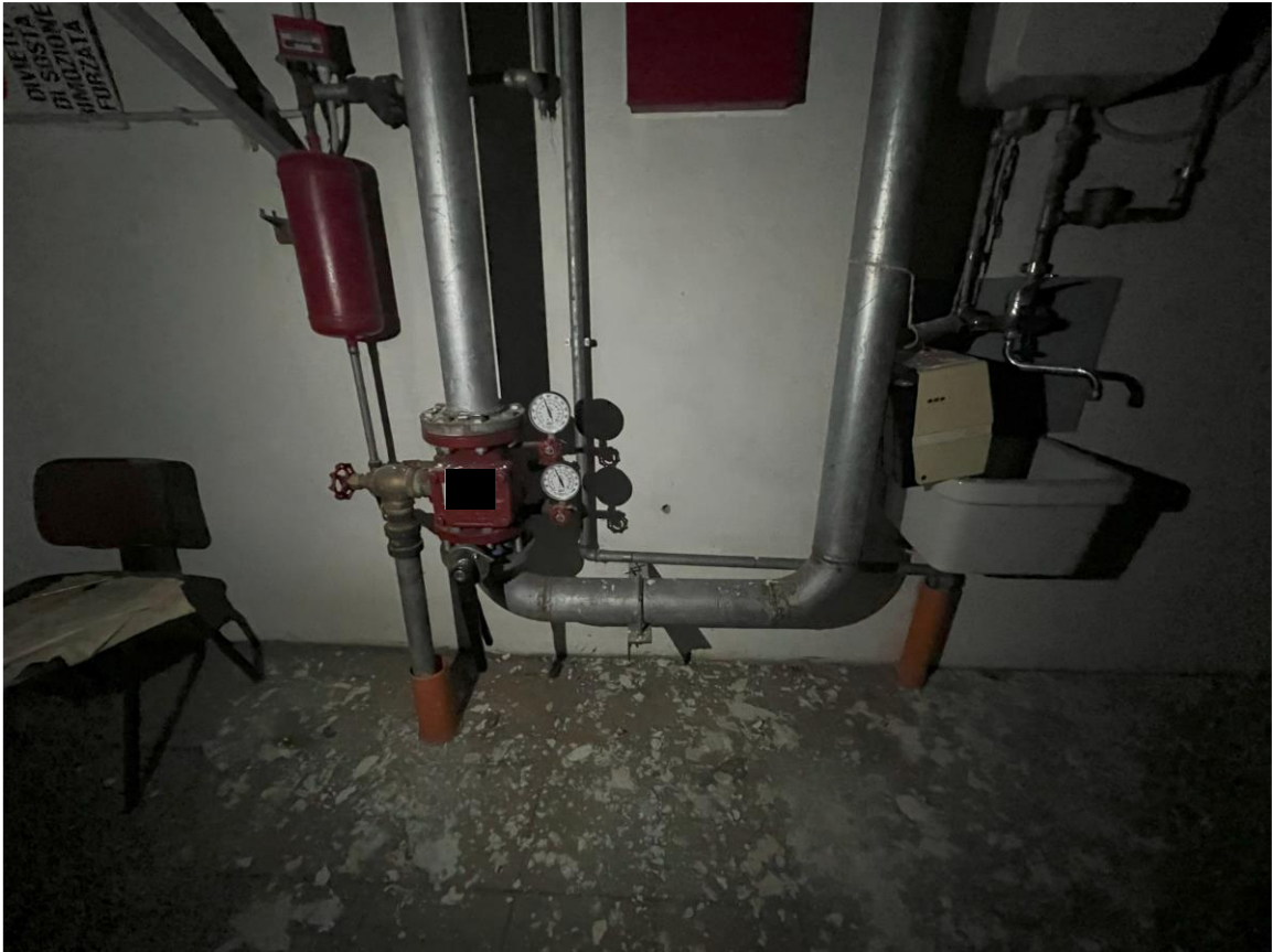
Foto 16. - Impianto antincendio in disuso
