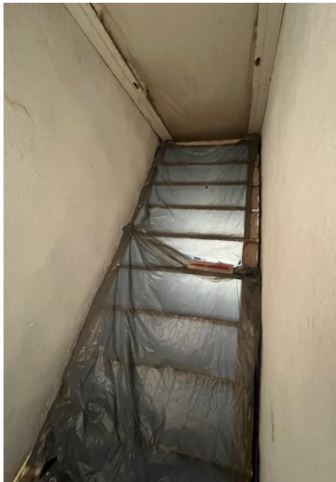
Fabbricato principale: scala di accesso alla soffitta, scala instabile quindi non accessibile
