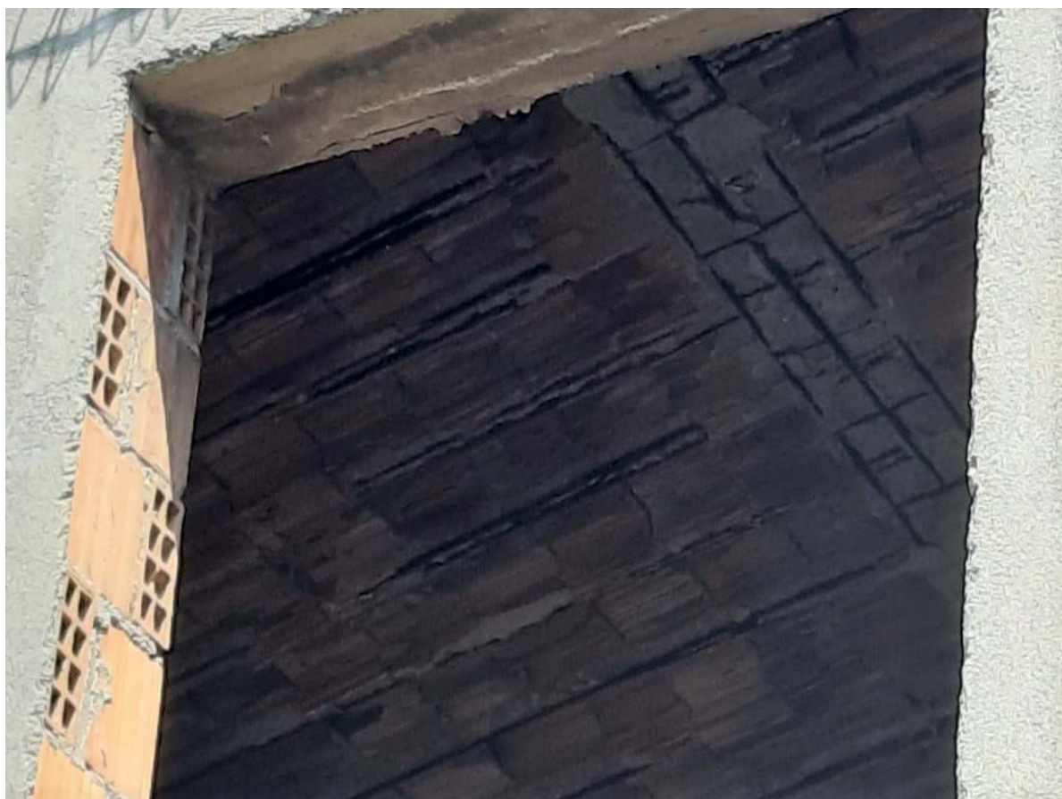
FOTO 4 : Particolare inerente il deterioramento della soletta di copertura al 1° piano
