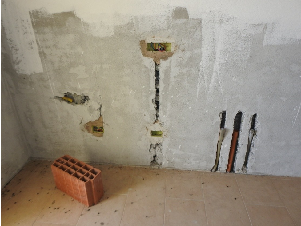
Figura 52 – Impianti non ultimati (cucina)
