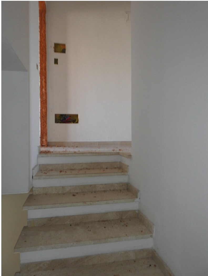
Figura 53 - Scatola di derivazione impianto elettrico, collegamenti mancanti
