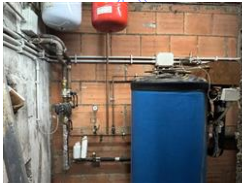
Caldaia non funzionante
