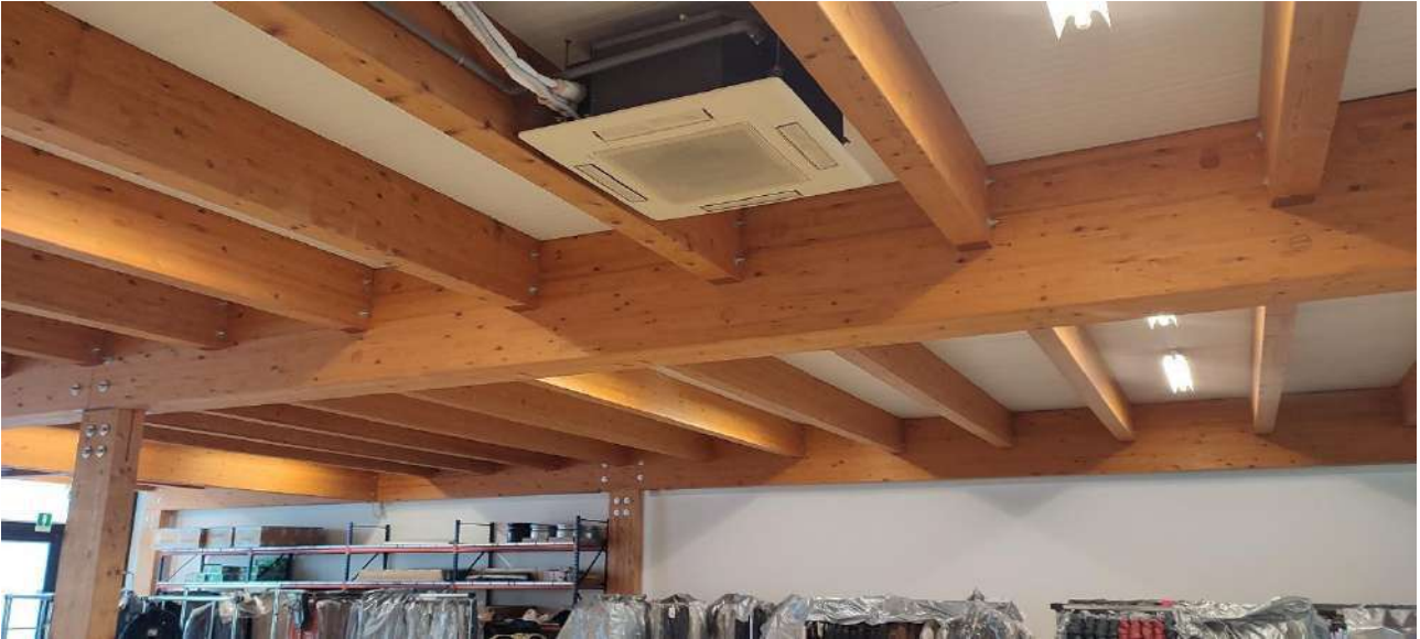
FOTO 10 - Vista interna - Intradosso sopralco con vista di apparecchio di distribuzione aria calda
