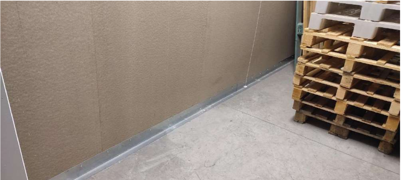
FOTO 18 - Piano primo soppalcato - altra vista interna - paretine in cartongesso ancorate a terra
