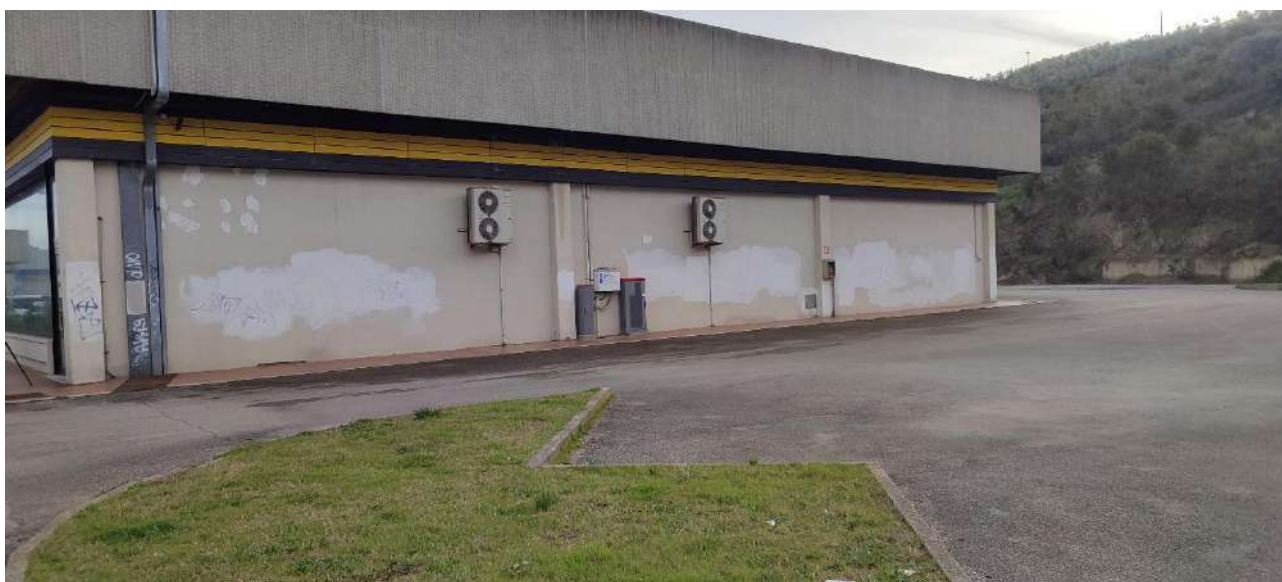
FOTO 3 - Altra vista da Nord di porzione del complesso immobiliare con vista di n. 2 pompe di calore installate a parete per riscaldamento invernale e raffrescamento estivo
