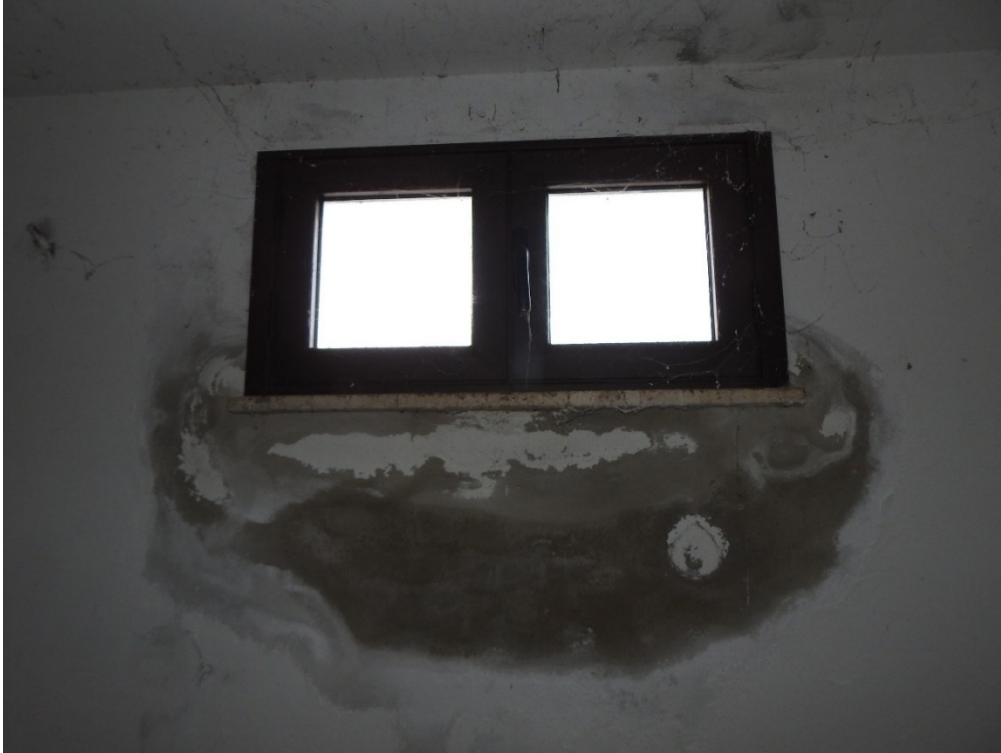
Figura 52 - Patologie edilizie, infiltrazioni in corrispondenza del serramento
