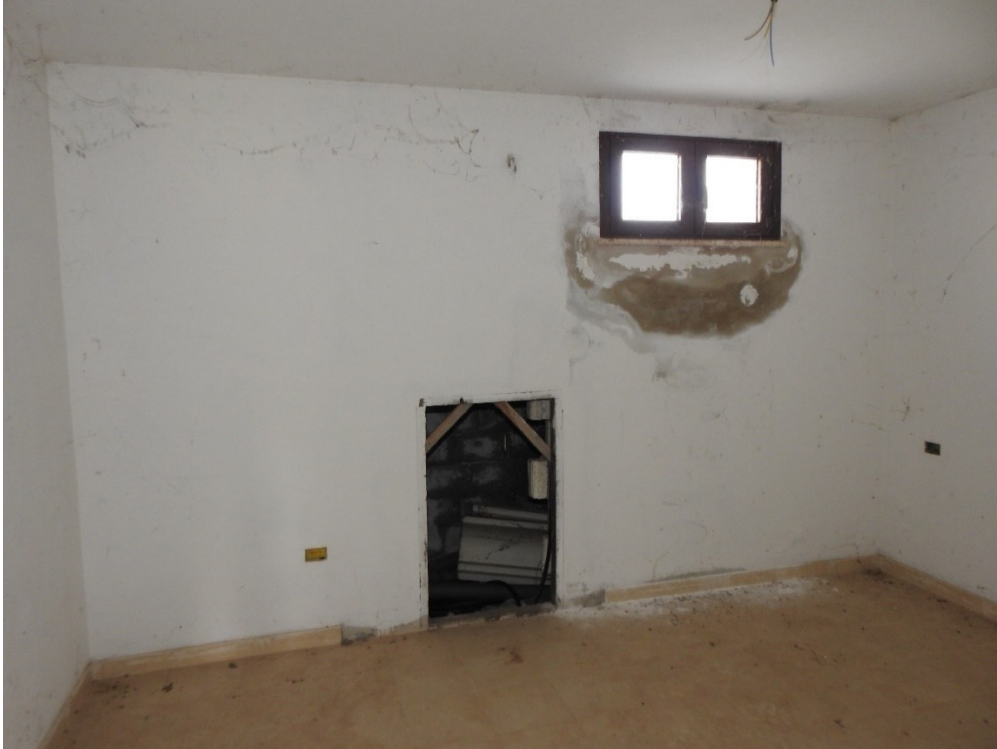
Figura 29 - Piano seminterrato, cantina. Si notino le infiltrazioni sotto l'infisso.
