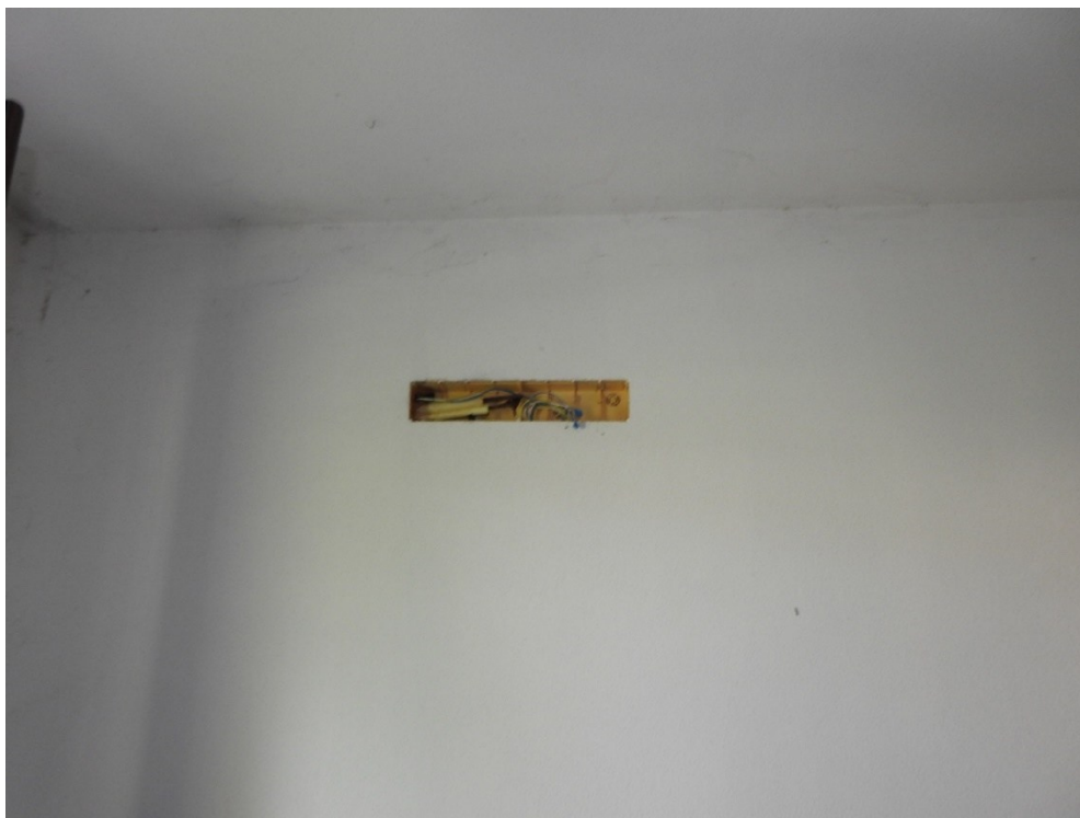
Figura 56 - Impianto di climatizzazione, predisposizione.
