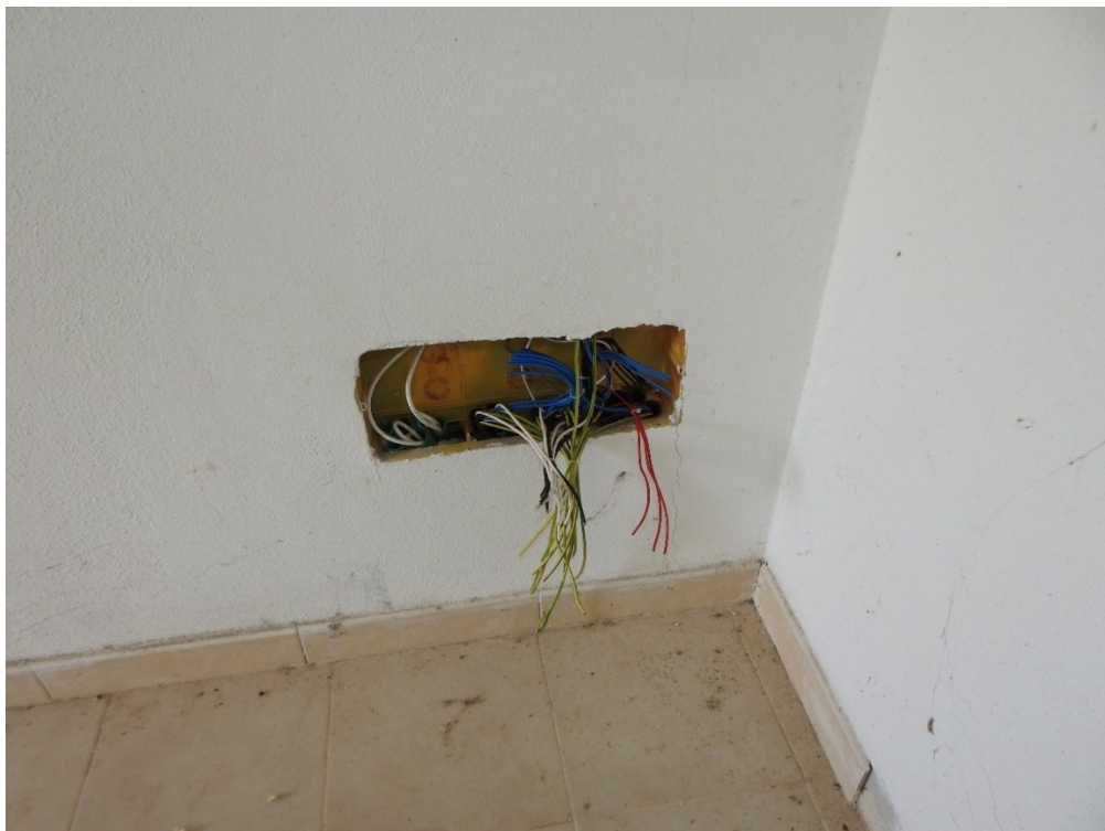
Figura 53 - Scatola di derivazione impianto elettrico, collegamenti mancanti
