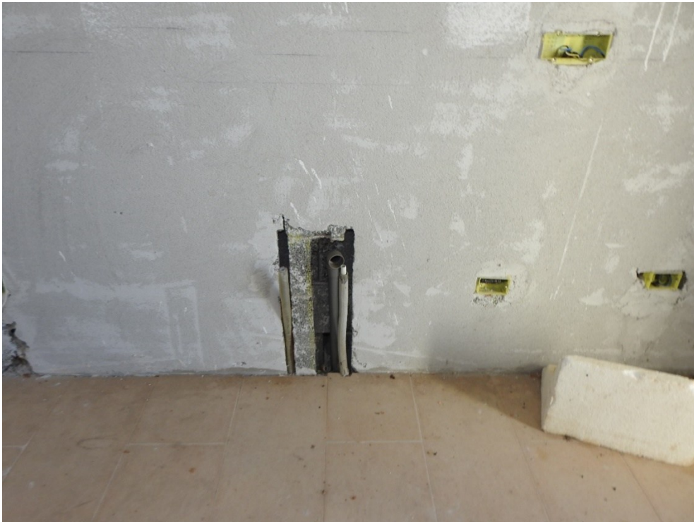
Figura 55 – Impianti non ultimati (cucina)
