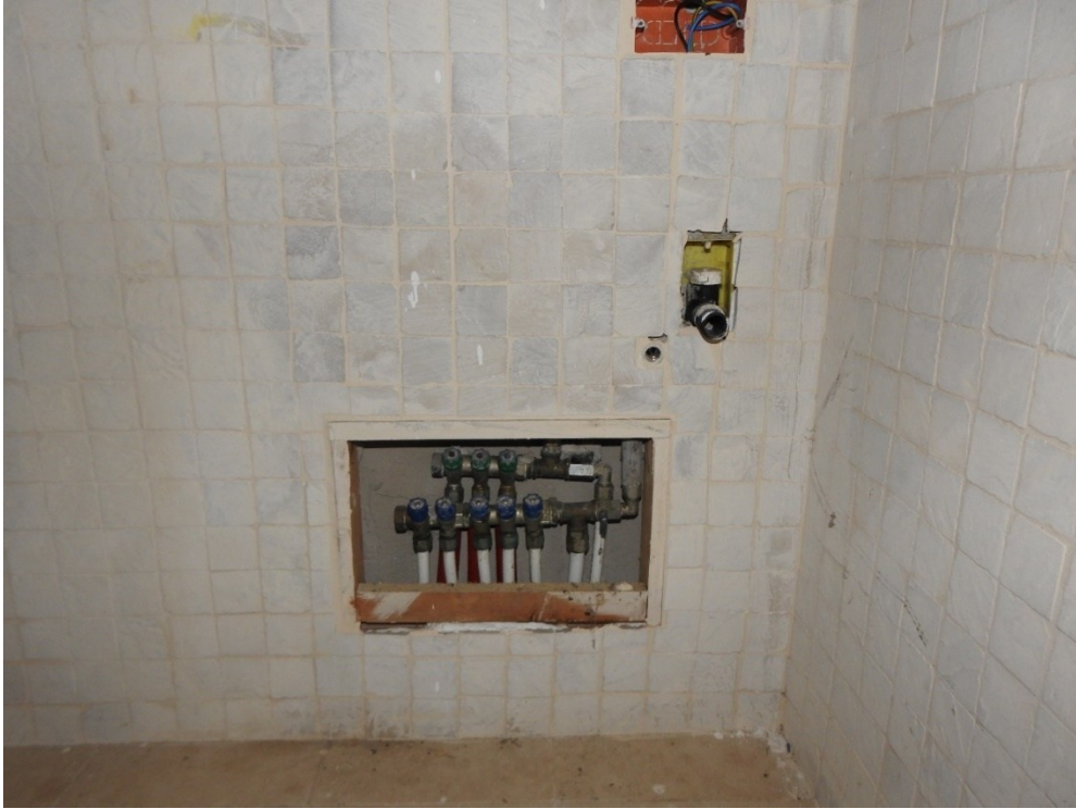
Figura 54 – Collettore impianto idrico piano seminterrato
