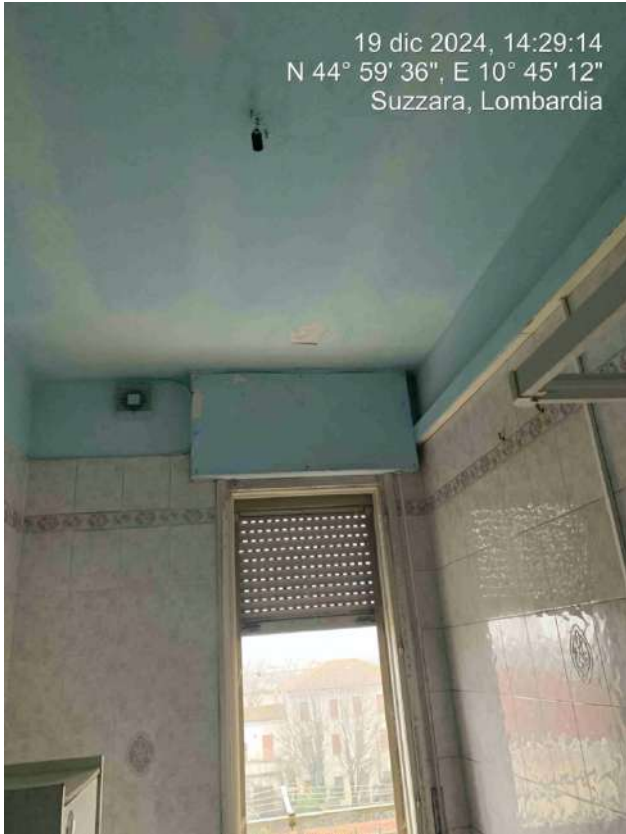
Particolare assenza serramento bagno
