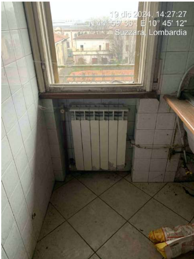
Angolo cottura - particolare serramento mancante
