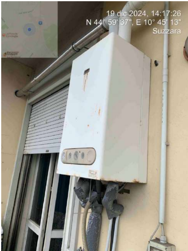
Caldaia Esterna su balcone
