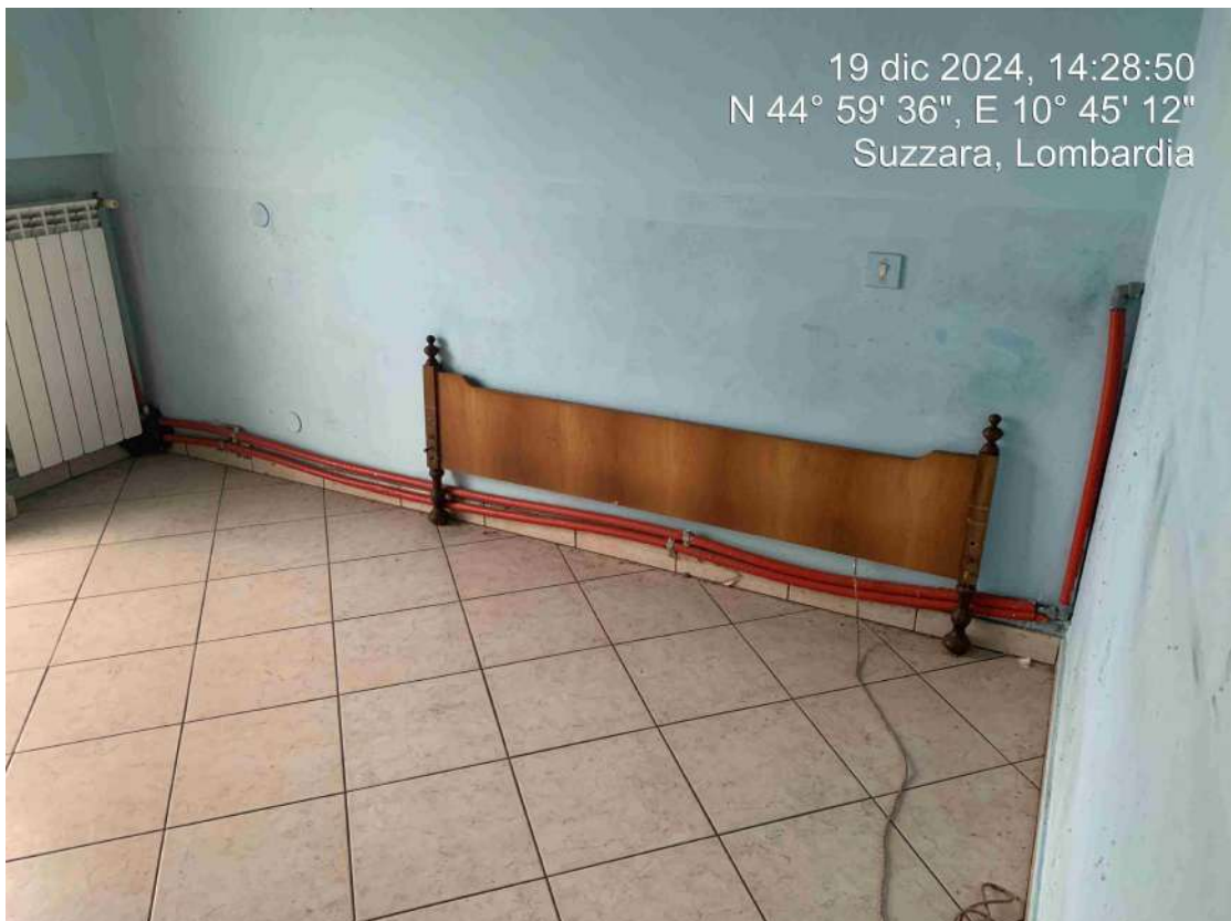
Stanza Letto - particolare tubazione termo-sanitaria esterna
