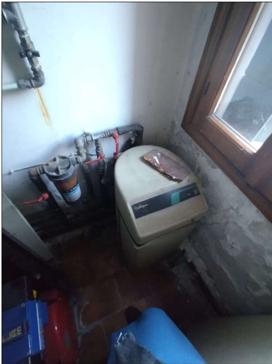
foto 28 -centrale termica comune
