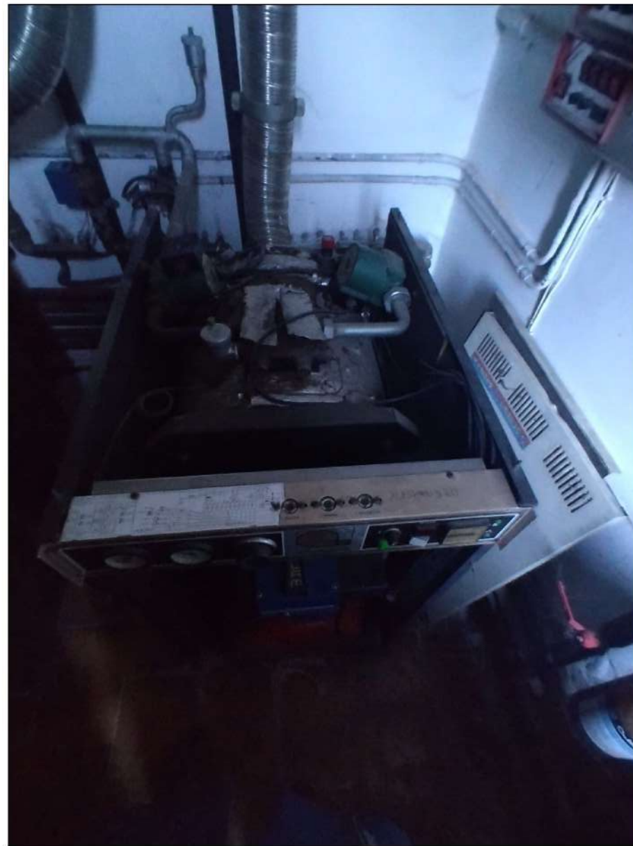
foto 29 - centrale termica comune
