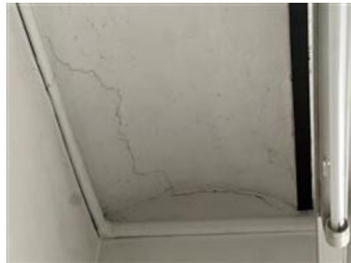
particolare di una delle fessurazioni presenti
