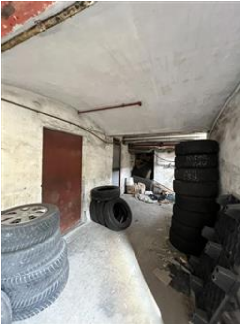
vista del piano cantine, la porta della cantina dell'immobile oggetto di pignoramento è l'ultima sulla sinistra
