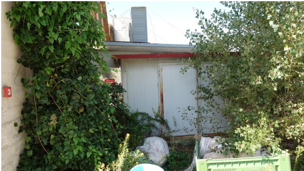
Foto 9 – edificio LP, destinato a locale pompe dell’impianto antincendio aziendale
