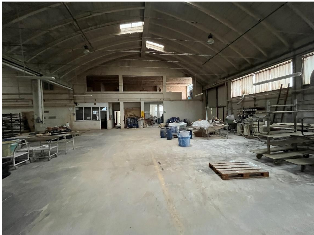
Foto 15 – opificio F1, navata Ovest, da Nord verso Sud, verso F2 al piano superiore, ingresso carrabile Sud nella parete destra.
