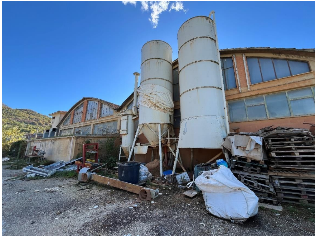
Foto 7 – Lato Nord dell'opificio F1, visto da Ovest verso Est, nei pressi del quale risultano ubicati e abbandonati materiali vari, silos e macchinari metallici. In secondo piano è visibile la sporgenza dell'edificio principale, costituente l'ampliamento destinato ai locali di umidificazione ed essiccazione, nonché ai gruppi elettrogeno e compressore Ga310.
