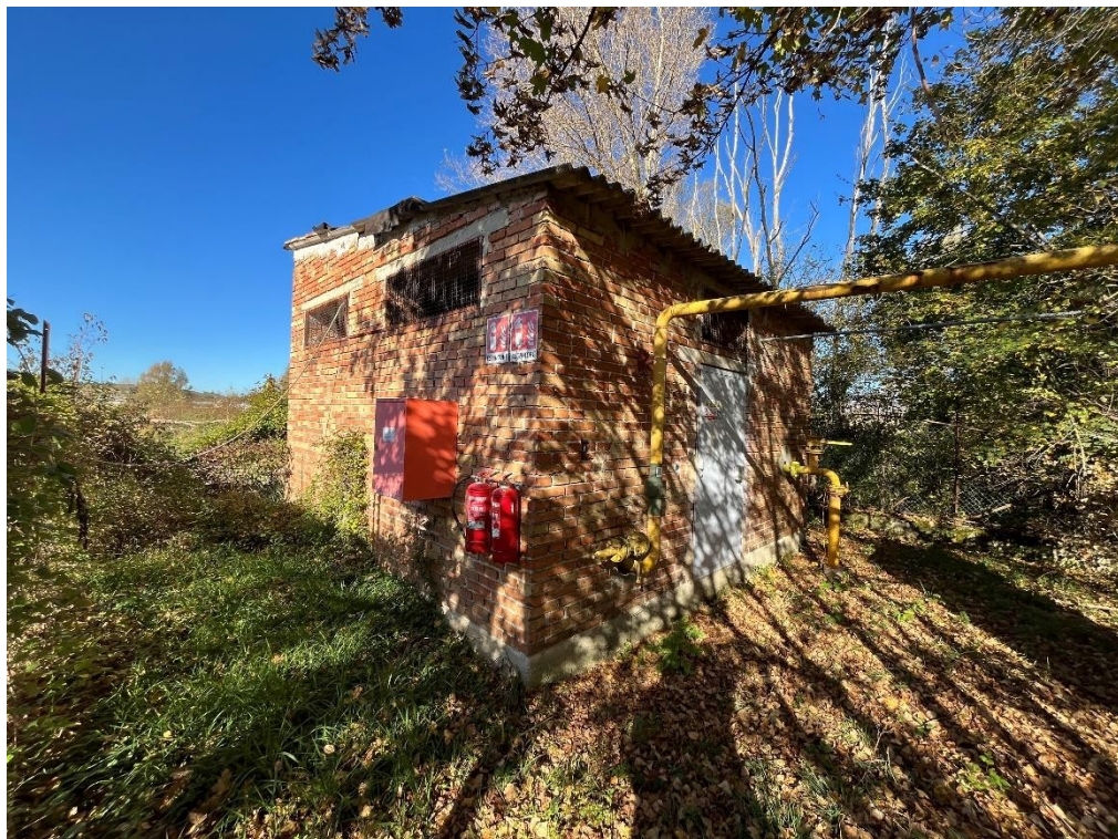
Foto 8 – cabina metano CM, ubicata nel piazzale F5 a Nord Est di LP, F3, F1.
