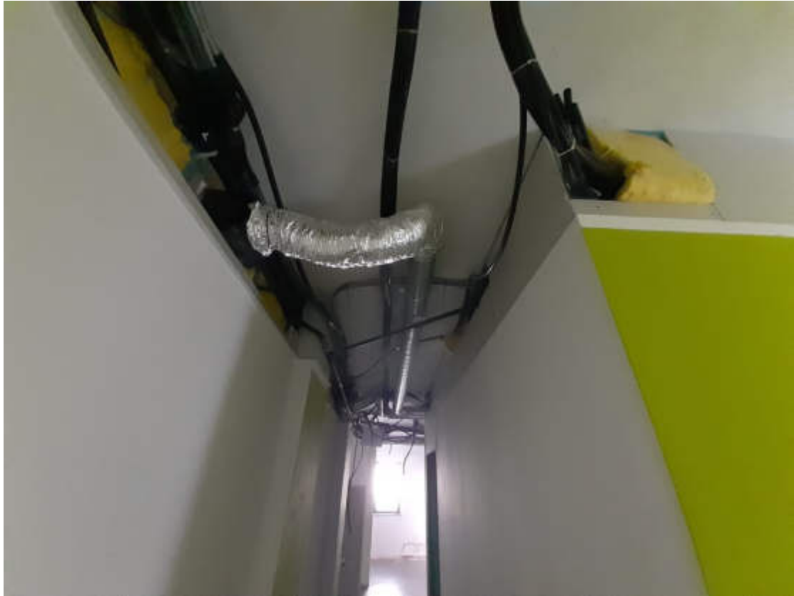
Dotazioni impiantistiche interne – quadri elettrici – trattamento aria
