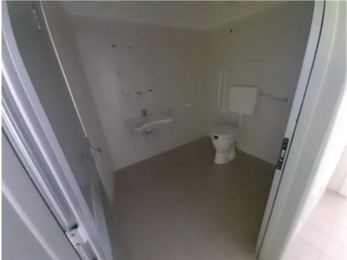
Vista interna locali bagno e dotazioni
